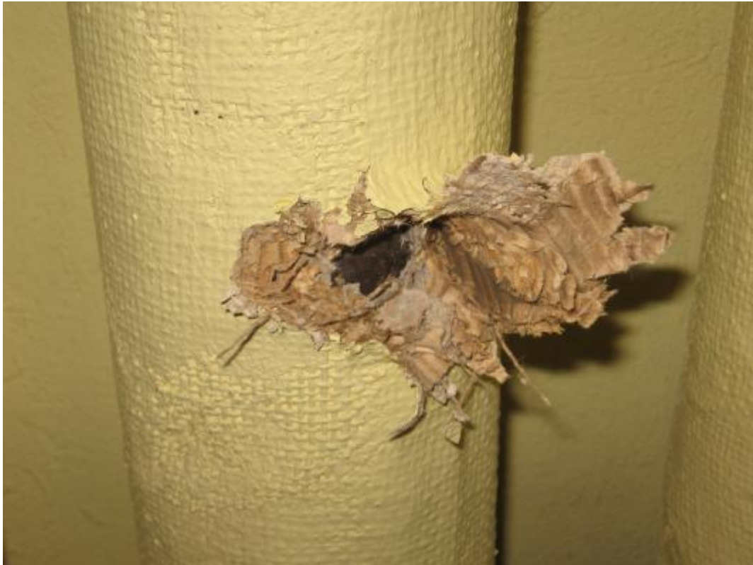
Kuva 7. Asbestipitoisella kuidulla eristetty vesiputki.
