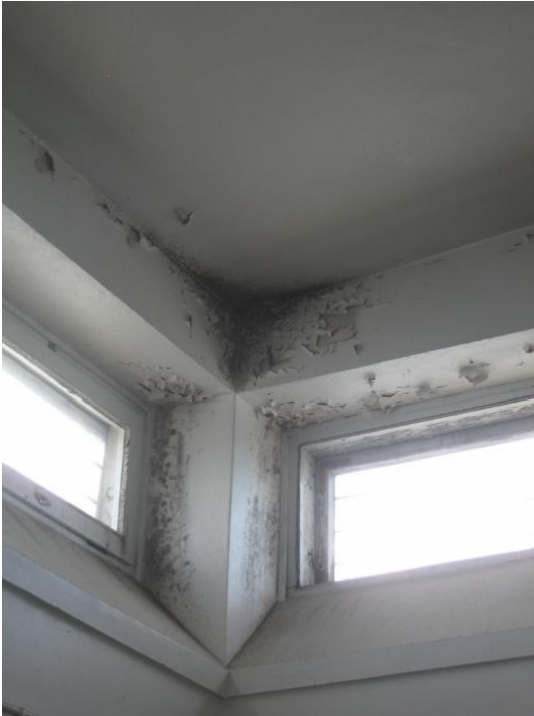
Kuva 9. Kosteus on päässyt makaamaan ulkoseinän rakenteessa.
