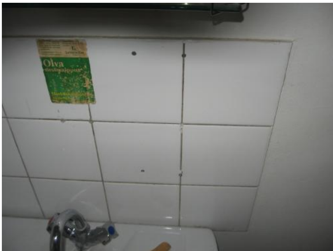
Kuva 8. Laatoituksen sauma- ja kiinnityslaasti sisältävät asbestia.
