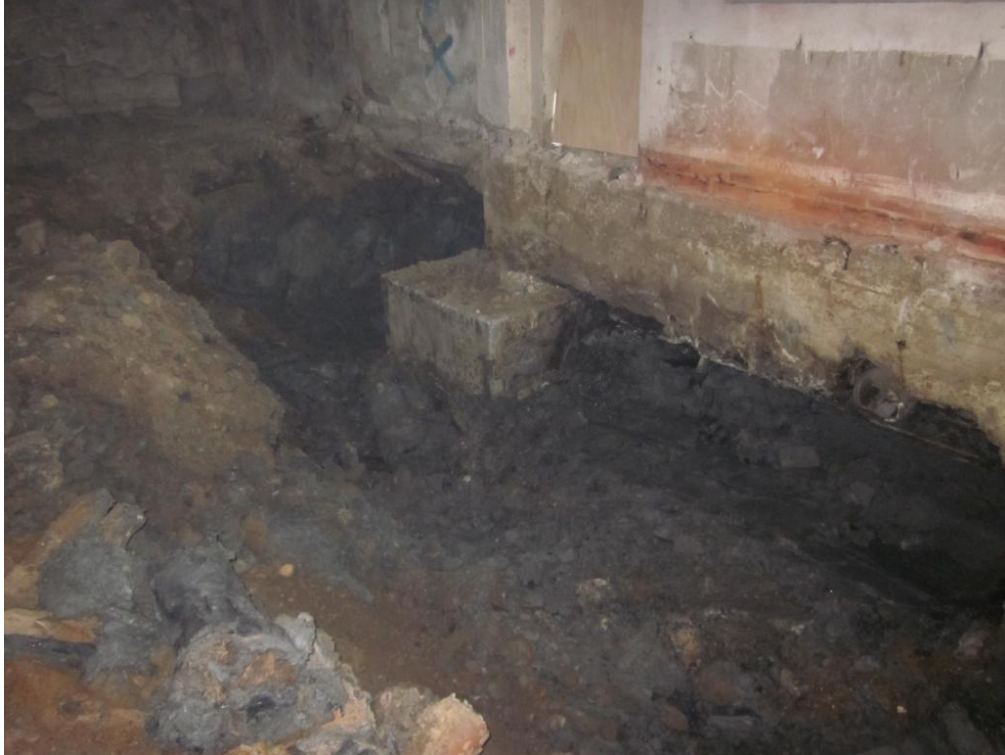
Kuva 16. Kuvassa on sokkelin alla kulkeva jäteputki ja pilaantunutta maainesta.
