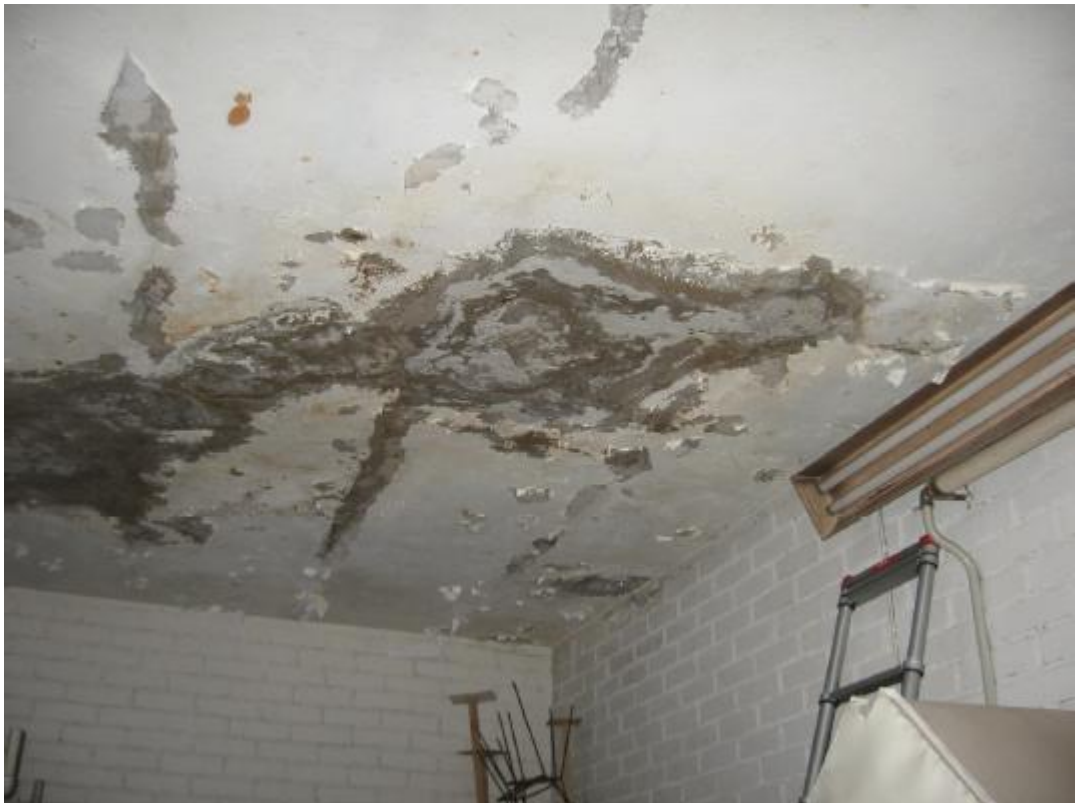
Kuva 10. Kuvassa vesikattoa, josta vesi on tullut läpi.
