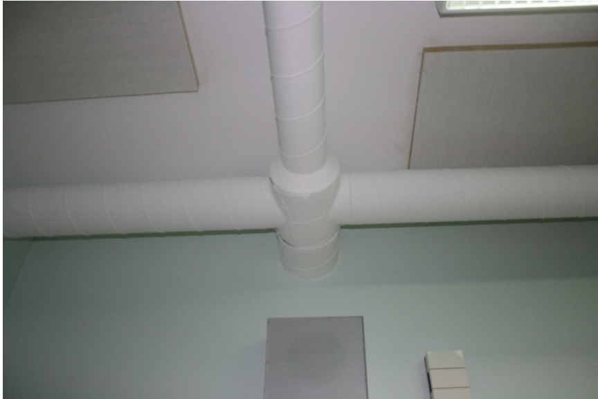
Kuva 6. Kaikissa tiloissa akustiikkalevyt eivät ole vierekkäin aseteltuna
