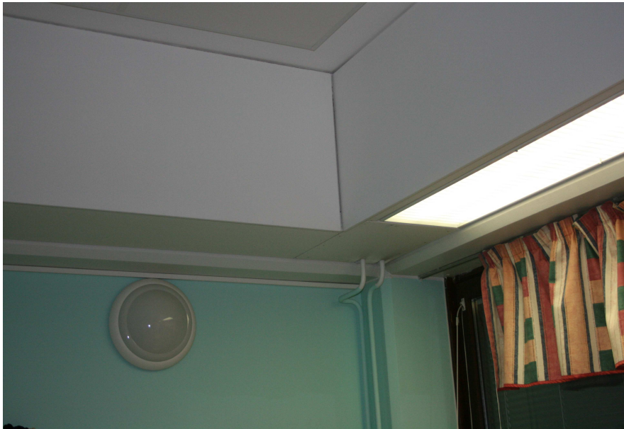
Kuva 7. Seinällä näkyvää säädettävää valaistusta ei uudistetussa tilassa tarvittaisi olla.
