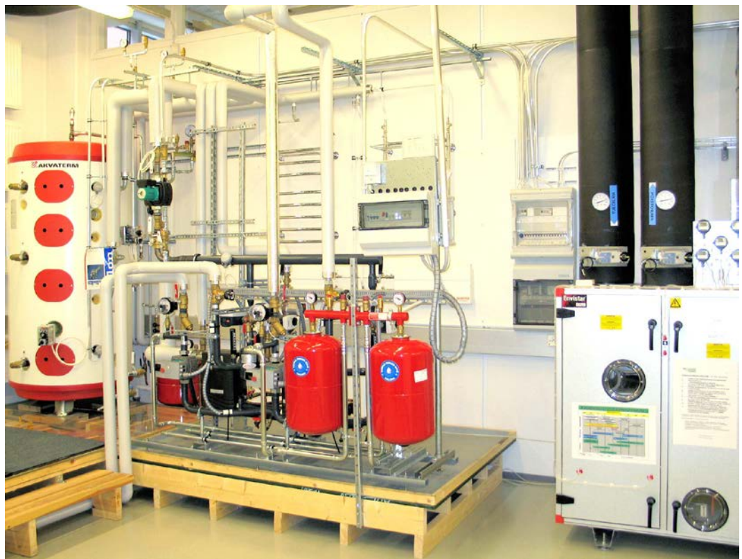
KUVIO 13. Kaukolämpövaraaja, kaukolämpöpaketti ja ilmanvaihtokoje
