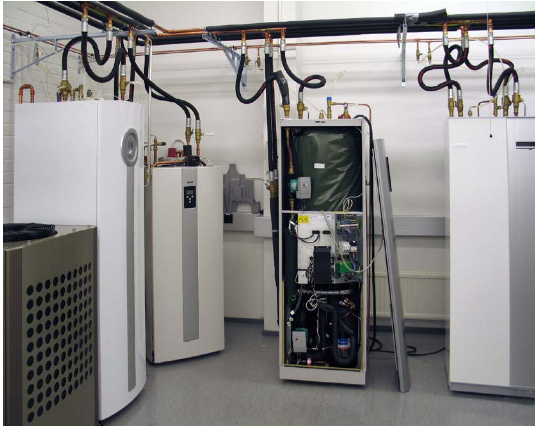
KUVIO 12. Maalämpöpumppuja ja niiden keruupiiri
