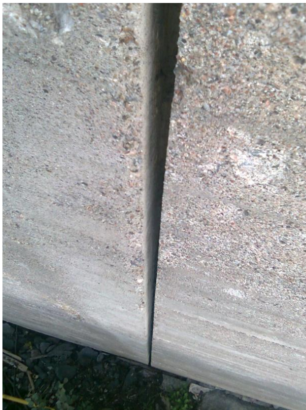
Kuva 33. Vanha liikuntasauma ylhäältä.
