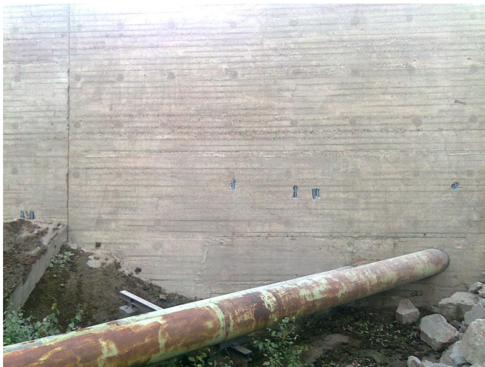
Kuva 44. Aktiivisesti toimiva putkiläpivienti lävistää vallin.
