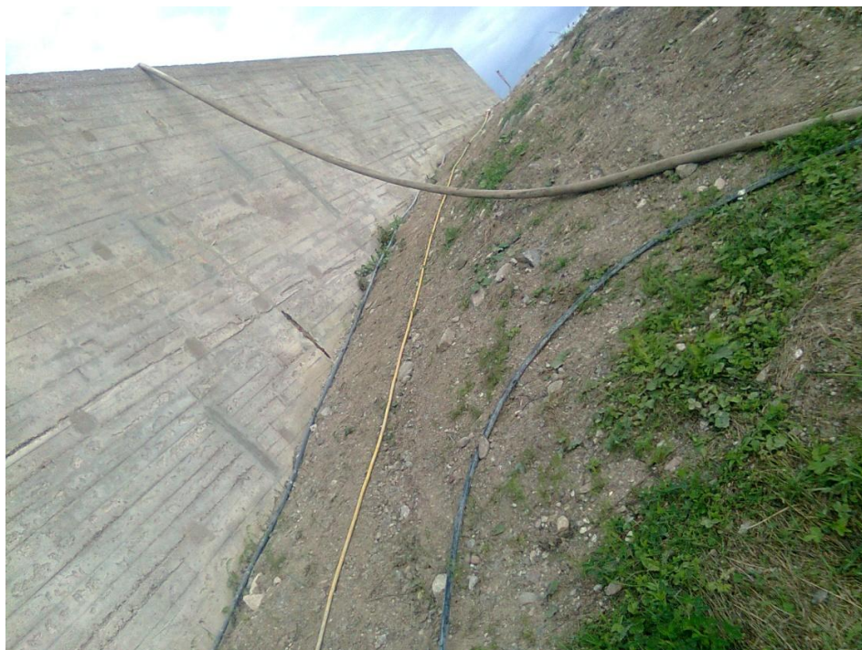
Kuva 13. Vesipiikkauksen vaatimat vesi, paine ja sähkövedot.
