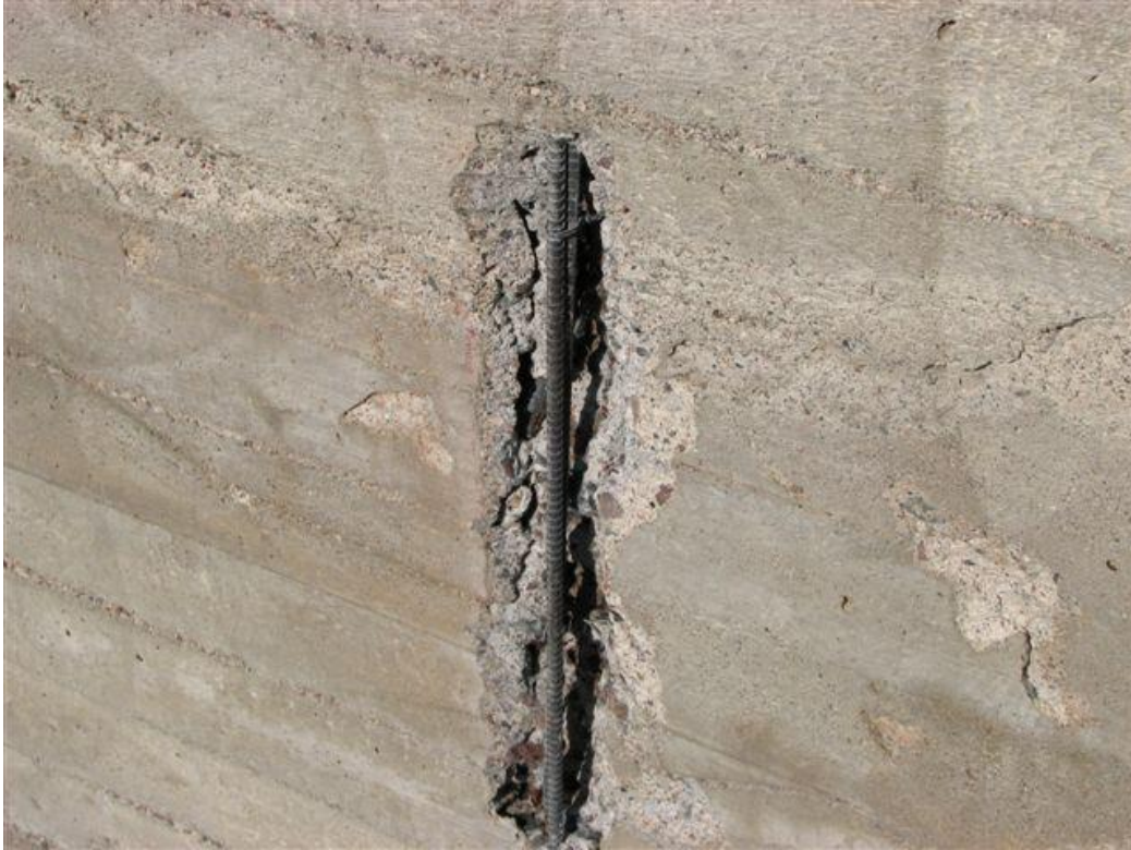
Kuva 4. Betoni rapautunut pois ja teräs paljastunut.
