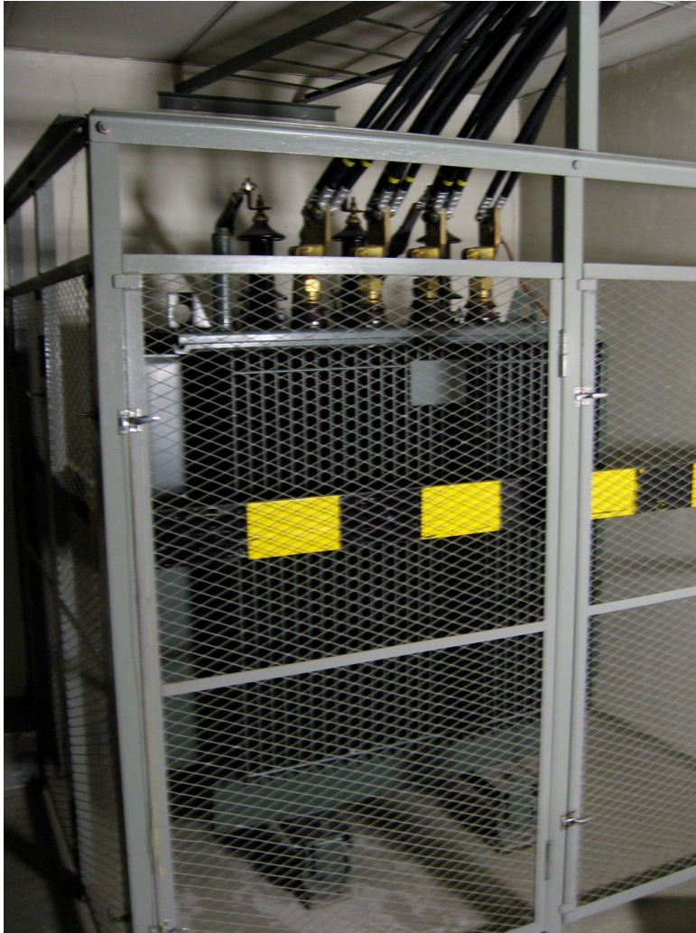
Kuva 2. Muuntamon 2553 muuntajan paljaat liitokset
