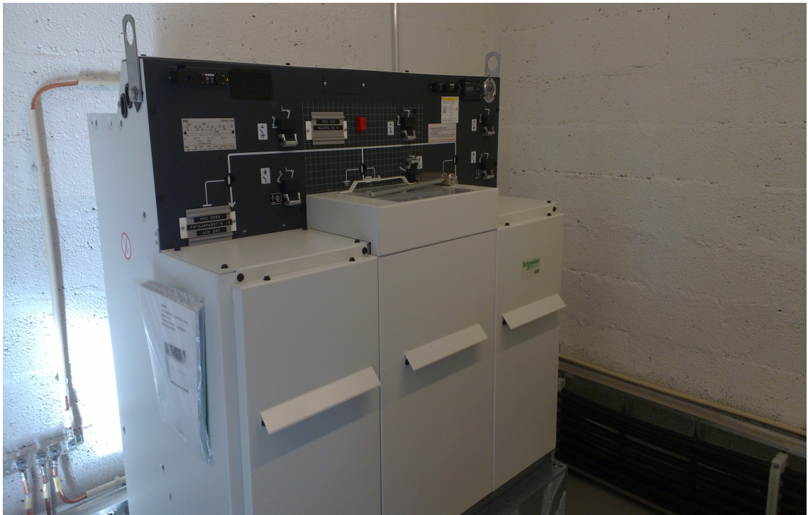
Kuva 4. SF6-kaasulla toimiva kojeisto
