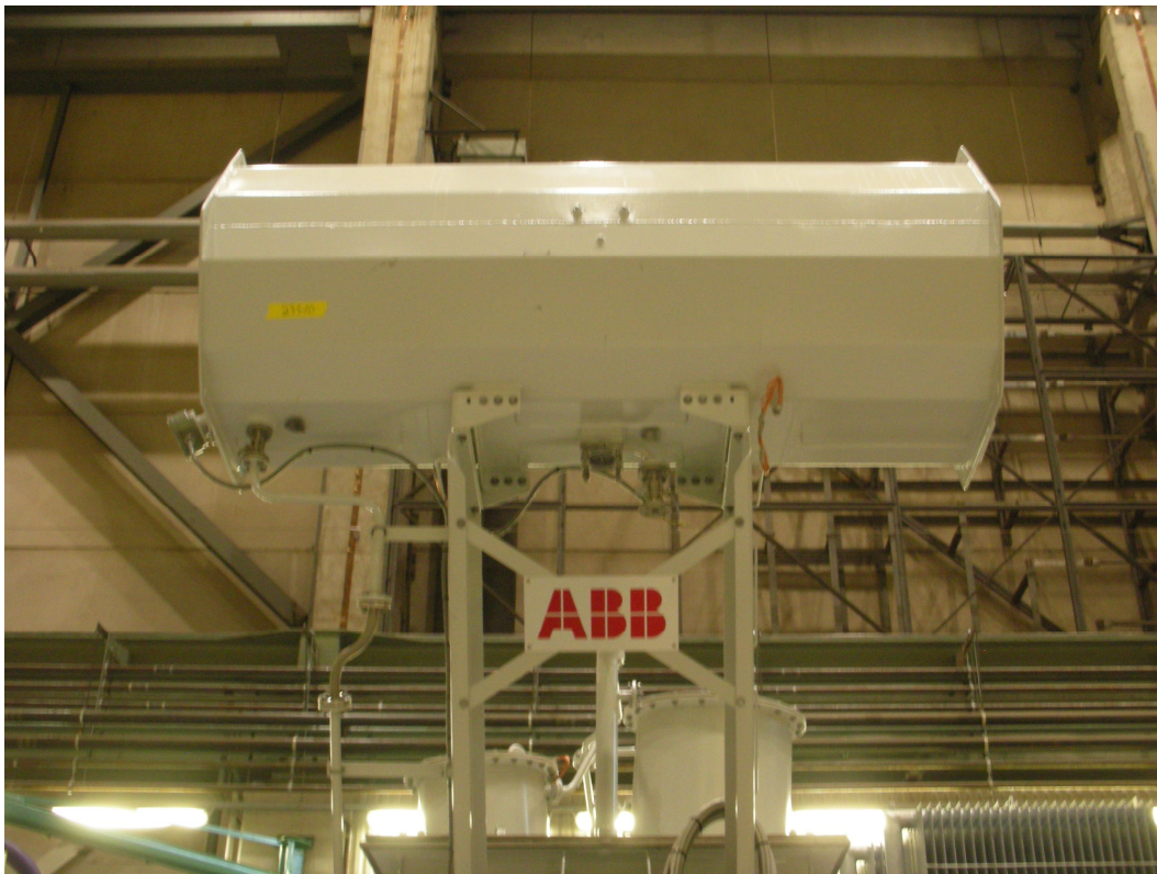
Kuva 5. Paisuntasäiliö kiinnitettyä muuntajaan
