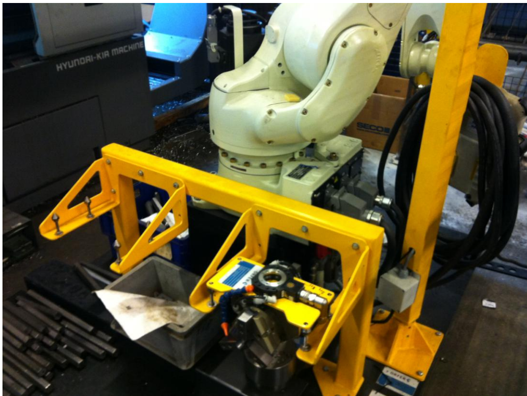
Kuva 18. Robotin työkaluteline. Vanha tarrain telineen oikeanpuoleisessa jigissä.
