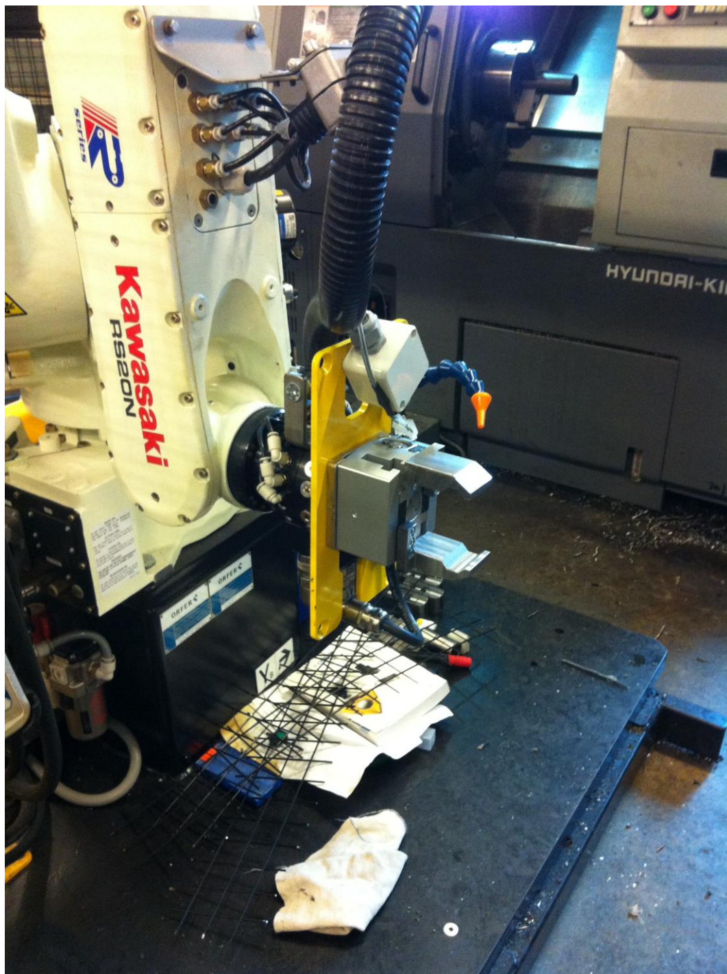
Kuva 29. Uusi tarrain robotissa asennettuna.
