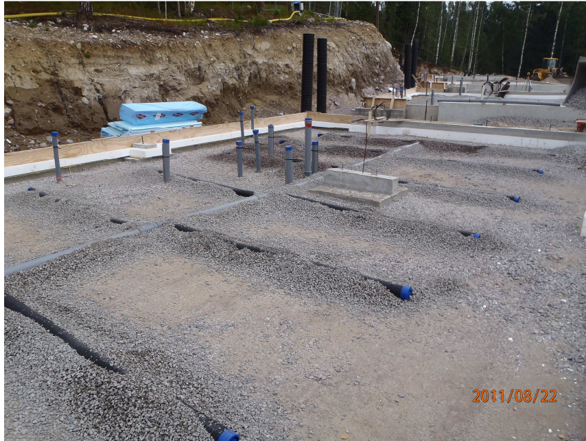
Kuva 4: Monihaarainen imukanavisto radonin poistamista varten. Poistoputki on merkitty punaisella värillä. (Kuva: Rafael Lindberg)
