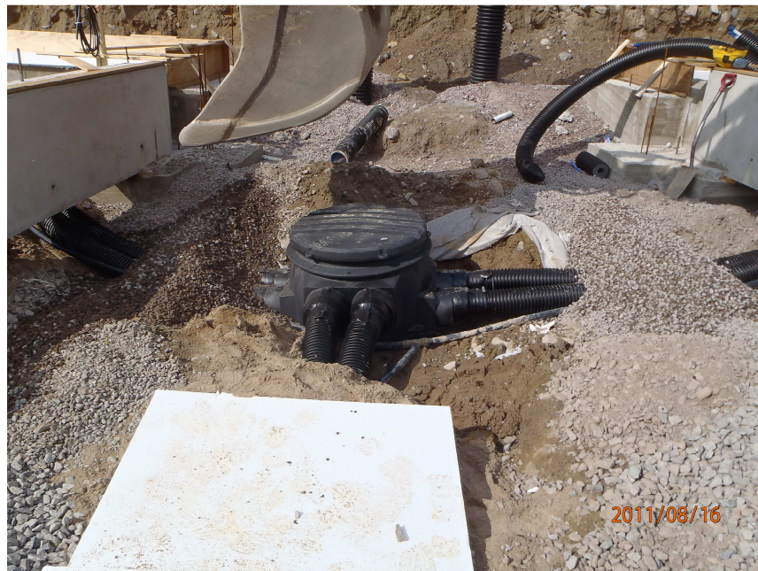
Kuva 9: Lämmönjakolinjaston haaroituskaivo. (Kuva: Rafael Lindberg)
