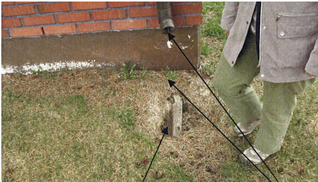
KUVIO 3. Betoniset loiskelevyt asennettu väärässä paikassa ja asennossa
