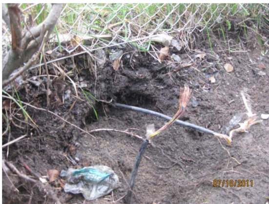
KUVIO 3. Kaivutyössä katkennut maakaapeli
