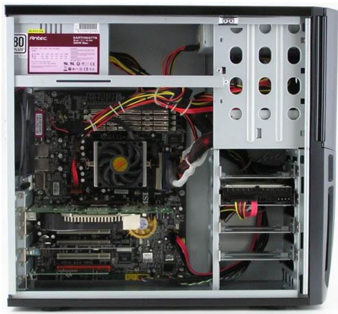
Kuva 8. Antec Sonata III -kotelon kaapelointi. [78.]
