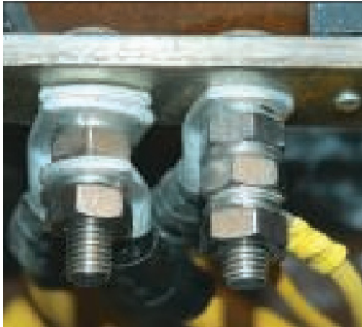
Kuva 19. Ruostumattomasta teräksestä olevat pultit osana virtapiiriä. Ruostumatonta terästä ei tulisi koskaan käyttää sähköjärjestelmässä virtaa kuljettavissa osissa, sillä ruostumattoman teräksen johtavuus on huono ja aiheuttaa siten suurta resistanssia. (Calder 2012, 57)
