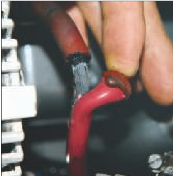
Kuva 8. Latausvirtakaapelin vahingoittunut eriste. Latausvirtakaapeli joutuu kovalle rasitukselle moottorin tärinän ja lämmön seurauksena. Hankaumat tulee tarkistaa kuukauden välein. (Calder 2012, 59)
