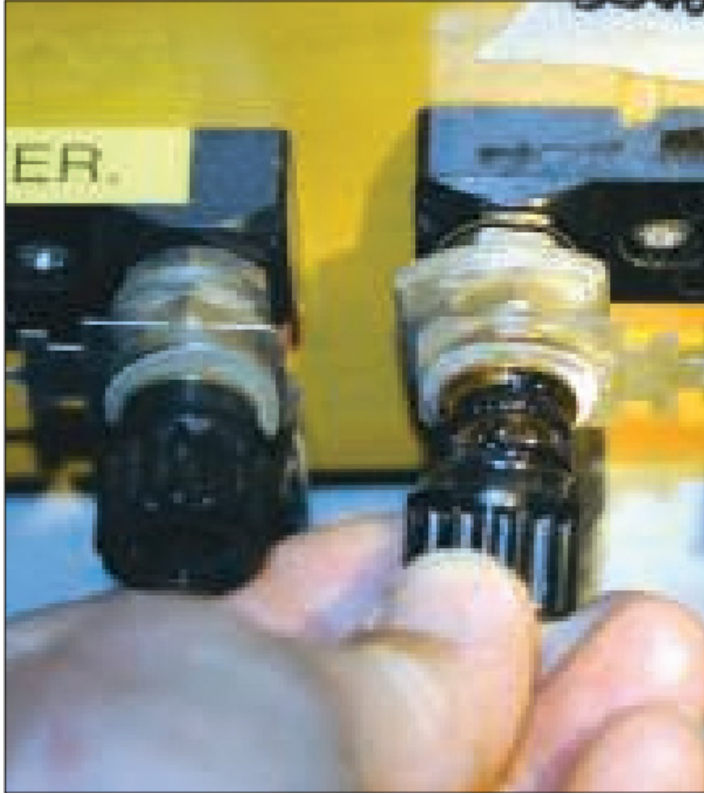
Kuva 24. Sulanut sulakepesä. Sulake ei suojaa virtapiiriä ylimenoresistanssin aiheuttamilta vahingoilta joita syntyy huonojen liitosten seurauksena erityisesti suurivirtaisissa virtapiireissä. Tällaisia vahinkoja voi välttää pitämällä liitokset puhtaina ja tarpeeksi tiukassa. (Calder 2012, 57)
