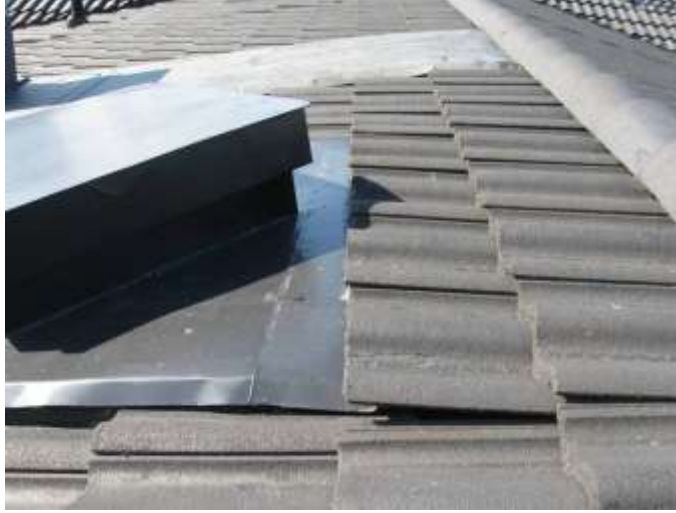
Kuva 37. Yläpohjan tarkastusluukku katolta. Tarkastusluukun reuna on noussut ja murtanut kattotiilen.
