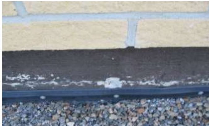
Kuva 31. Rakennuksen sokkelista karissut maali.
