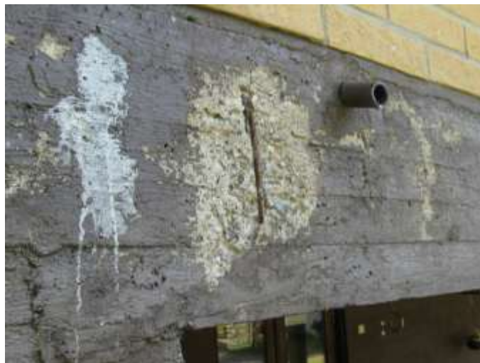
Kuva 32. Palkista esiin tulevat raudoitukset.
