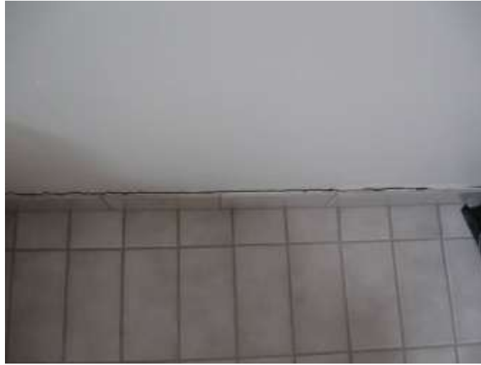
Kuva 38. Alakerrassa laatat irronneet seinästä.
