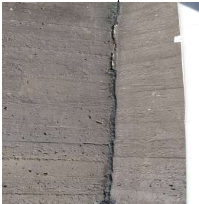
Kuva 35. Ulkoseinien liitoskohdan saumaus on hajonnut.
