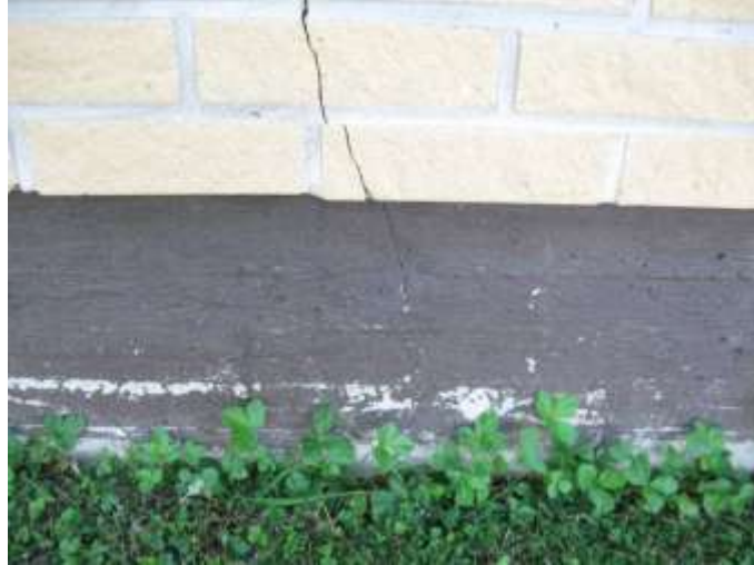
Kuva 33. Julkisivussa oleva halkeama.
