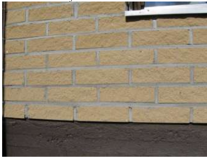
Kuva 34. Tiiliverhouksesta puuttuva tuuletus.
