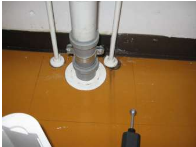
Kuva 39. Henkilökunnan taukokuoneessa puutteellinen putken ja lattian tiivistys.
