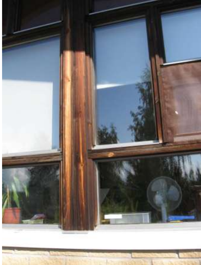
Kuva 36. Rakennuksen eteläpuolen ikkunat, joissa auringon paisteen kuluttama lakkaus.
