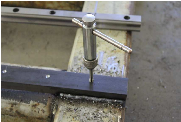
Kuva 5. Pylvään johdepintojen kierteytys.
