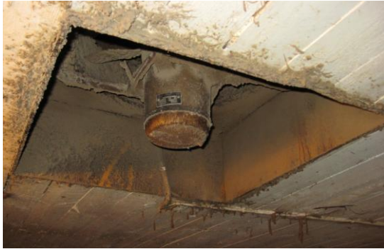
Kuvio 13. Nuorkarjatilojen matalalle poistohormiin asennettu poistopuhallin.
