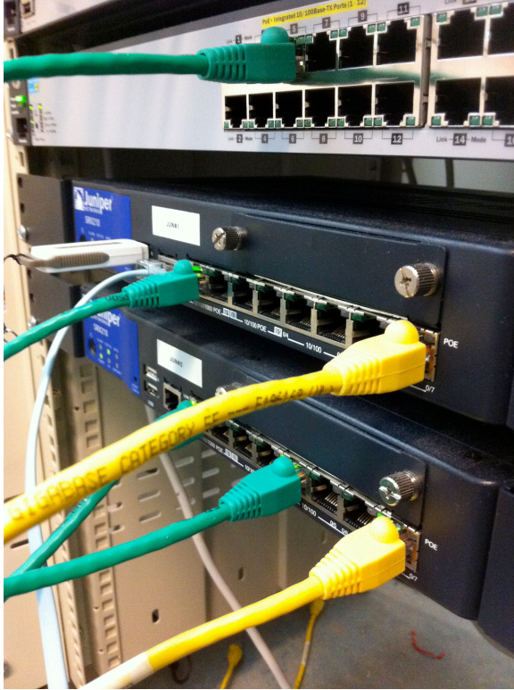
Kuva 1. Laboratorioverkon kytkennät. Kaksi alinta laitetta ovat laboratorioverkon Juniper SRX210 -laitteet.
