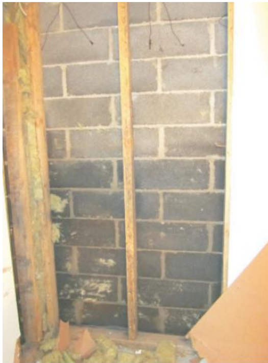
Harkkoseinän alaosa kapillaarisessa tilassa.
