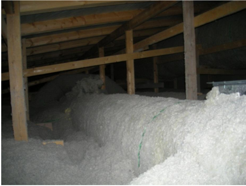
Kuva 26. Tuulettuvassa yläpohjassa olevat kanavat, jotka lämmitävät kattoa
