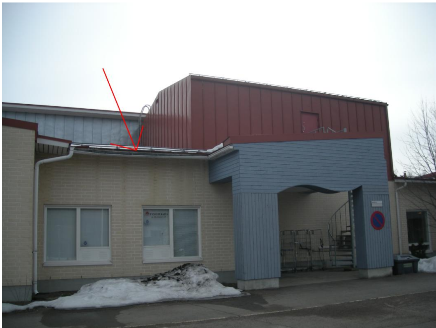
Kuva 25. Fysioterapiahuoneiden katolla ollut jää on vahingoittanut räystästä.
