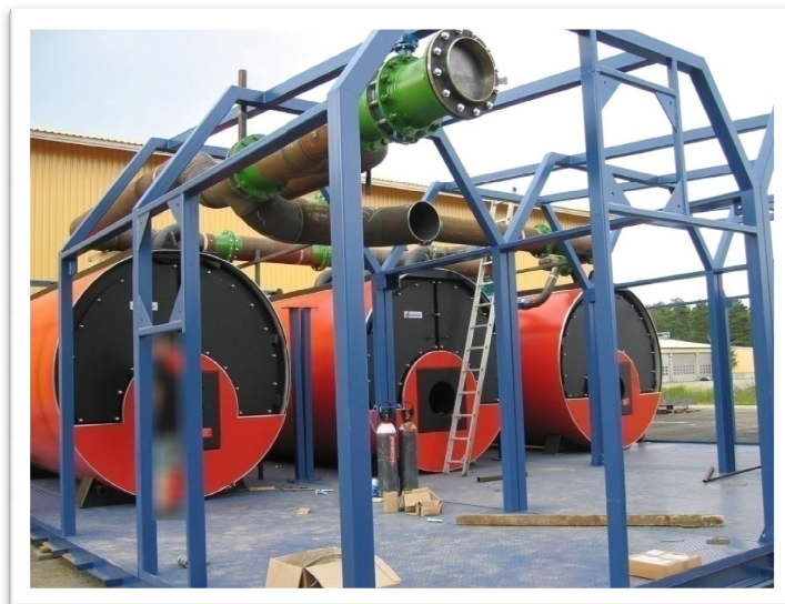
KUVA 8 Yritys Fineuropol KY:n valmistama 3:n kattilan lämpökeskuksen runko ja osa vesiputkistoa.
