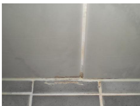
Kuva 13 Suihkunaikana jatkuvan vedenvaikutuksen alainen kohta
