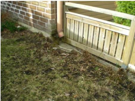
Kuva 19 Loiskekuppi on liian pystyssä ja vesi roiskuu siitä seinään
