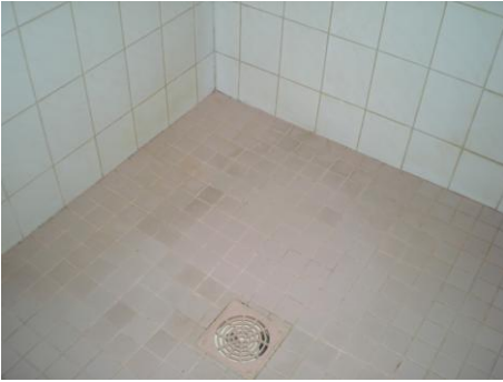
Kuva 15 E12 pesuhuoneen suihkun ja lattiakaivon välillä lattialaatat ovat irti alustastaan
