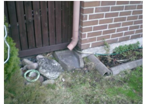
Kuva 21 Poistokourusta on tehty kukkapenkin reuna ja siksi sadevesi jää rakennuksen viereen
