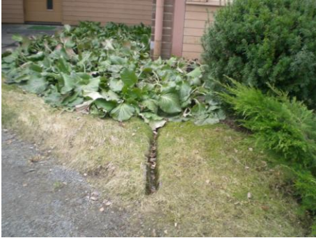
Kuva 15 Sadevedenpoisto kouru ei johda vettä
