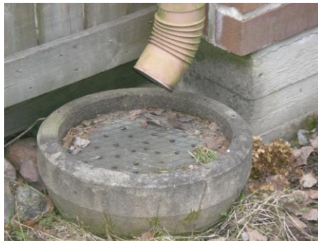
Kuva 19 Takapihan sadevesikaivo, jonka vedenjohtokyky ei riitä kovilla sateilla
