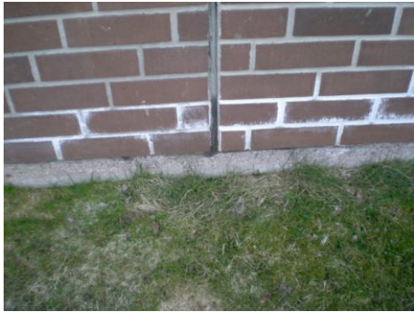
Kuva 8 Kalkkihärmää ja puuttuva vedenpoistoreitti
