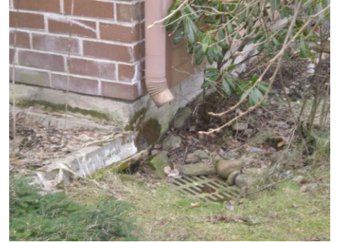
Kuva 17 Syöksytorven etäisyys sadevesikaivosta on liian suuri
