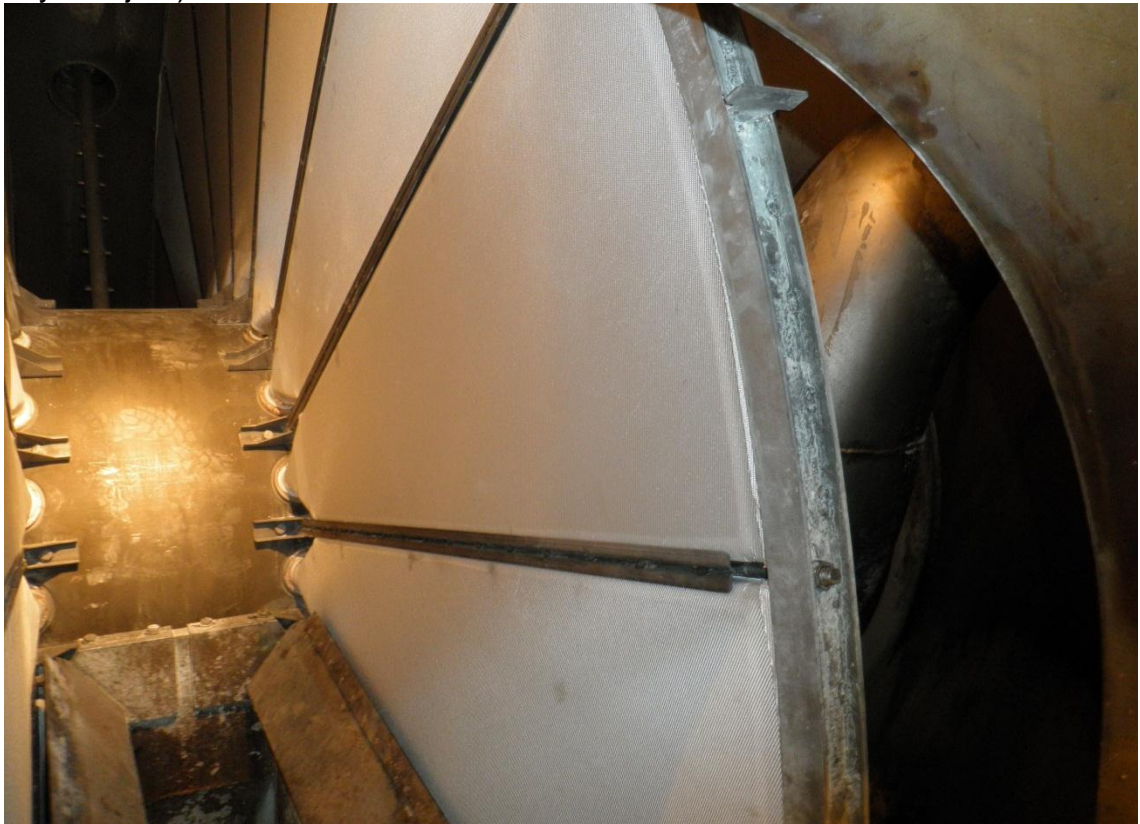
Kuva 15. Paineistetun kiekkosuotimen suodatuskiekko ja kaavarit.
