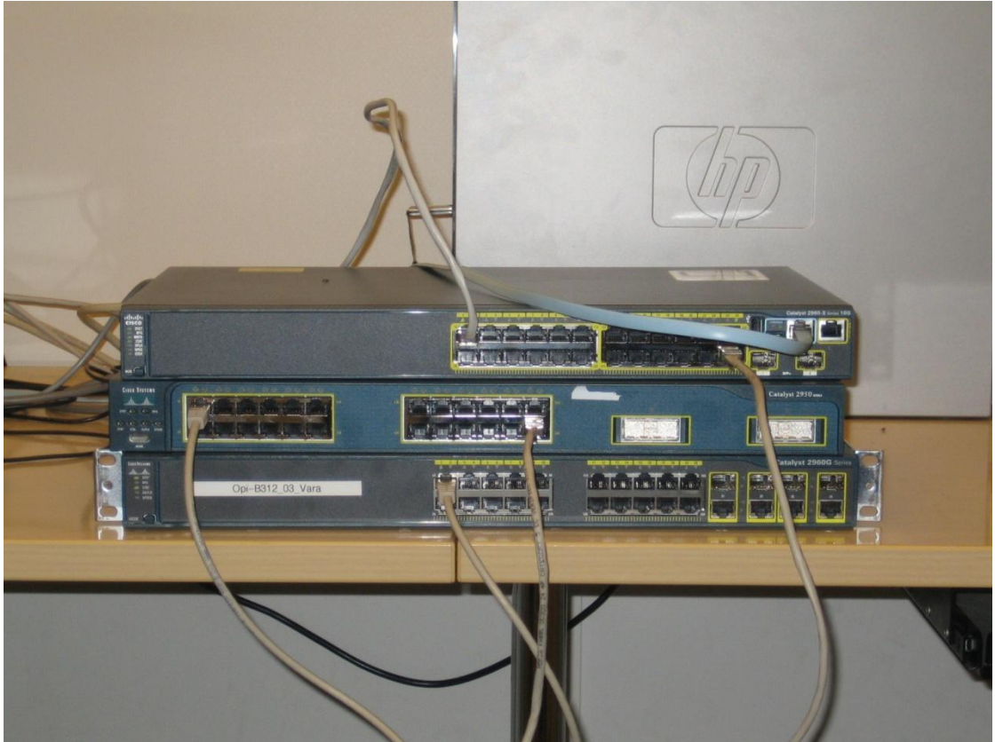
KUVA 5. Testauksessa käytetyt kytkimet. (Valokuva Miika Räisänen 2012)
