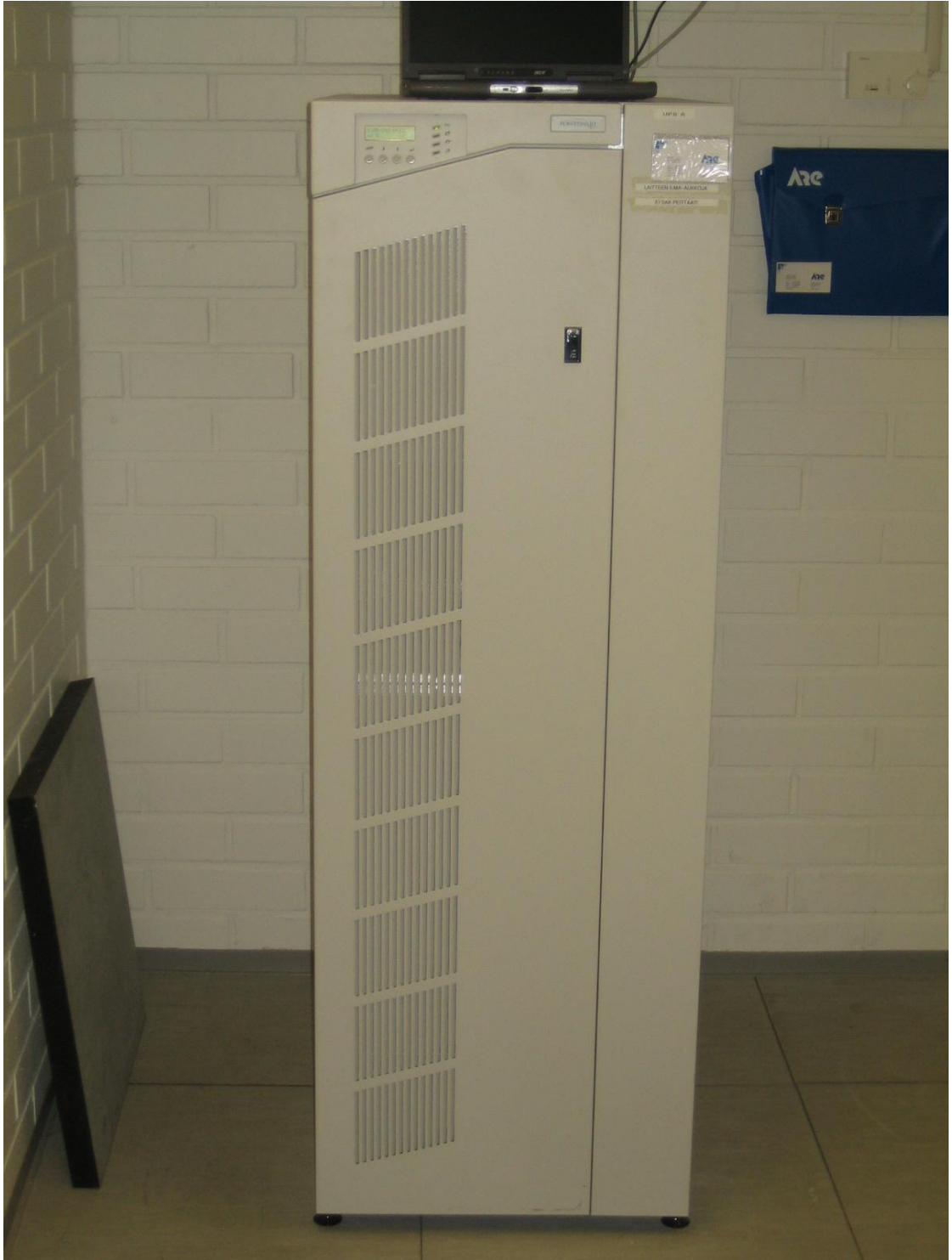
KUVA 1. Kuva Savonia-ammattikorkeakoulun palvelinhuoneen UPS:sta. (Valokuva Miika Räisänen 2012)
