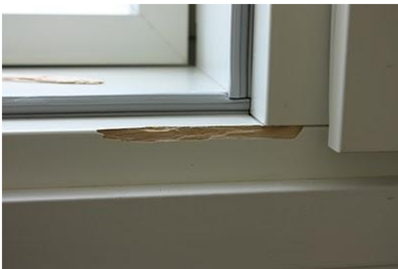
Bild 30. Skadad fönsterkarm (Rauhalan rakentajat 2012).
