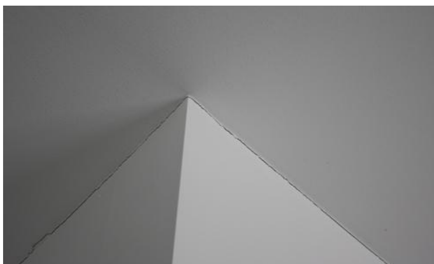
Bild 20. Sprickbildning mellan väggar och tak (Vi bygger ett hus 2012).
