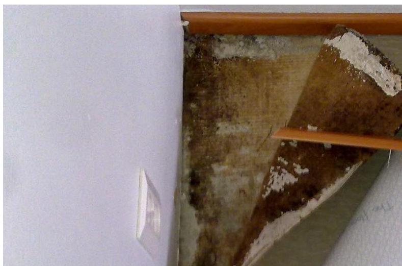
Bild 17. Mögelskada under plastmatta (Olli-Pekka Lamminheimo 2012).
