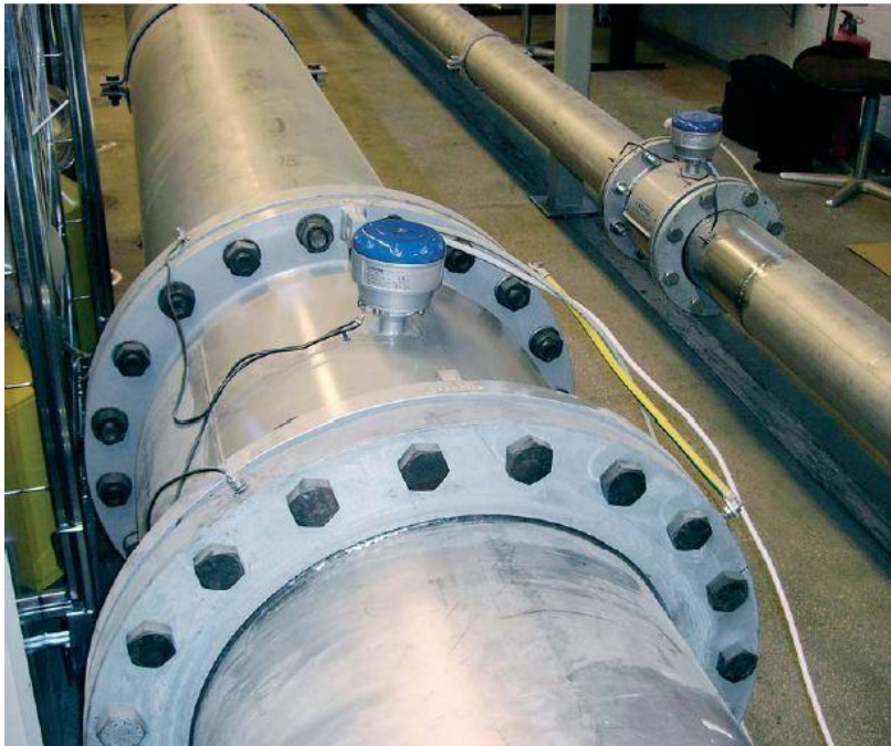
Kuva 5. Sähkömagneettinen virtausmittari asennettuna virtausputkistoon.[5]
