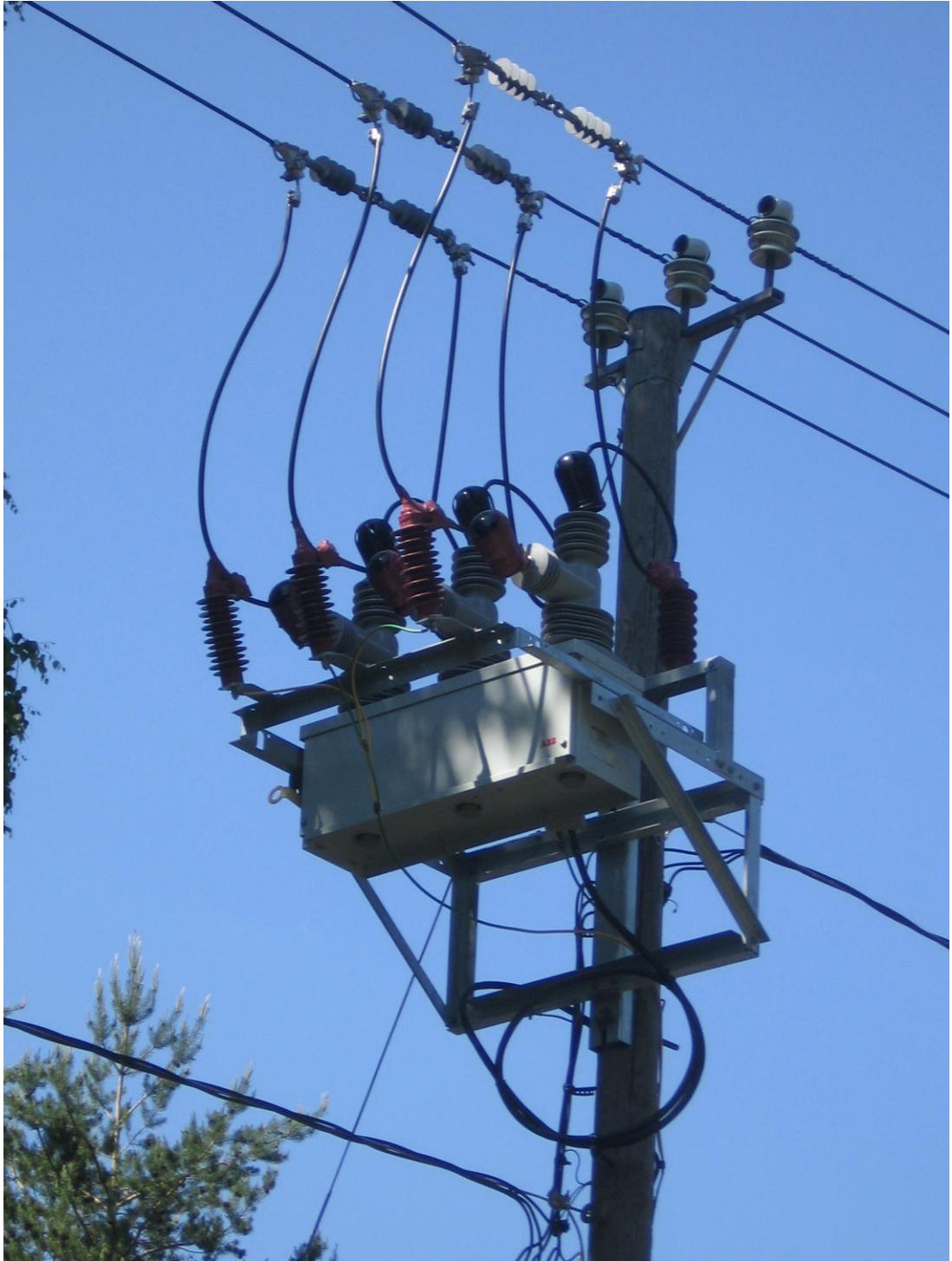
Kuva 9. Pylväskatkaisija Iitin Kömmistössä.
