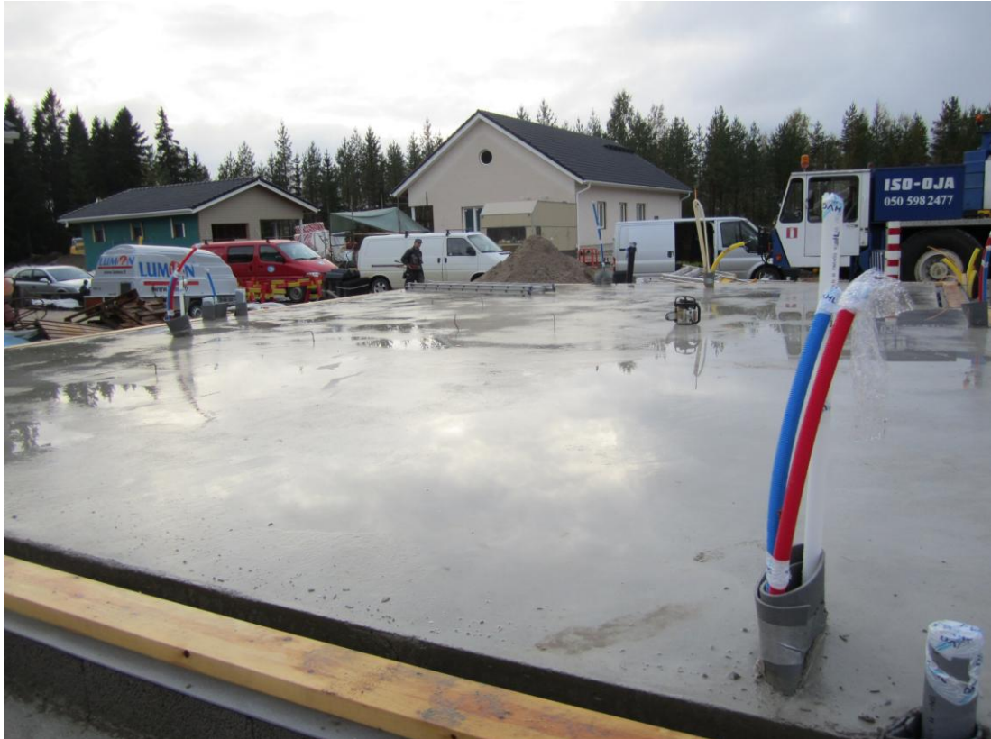
KUVA 10. Kastunut betonilaatta suojapeitteiden poistamisen jälkeen
