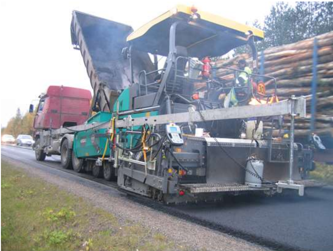
Kuva 1. Skanska Industrial Solutions Oy:n levittäjä tekemässä massapintausta (kuva: Pentti Katermaa, Skanska Industrial Solutions Oy).
