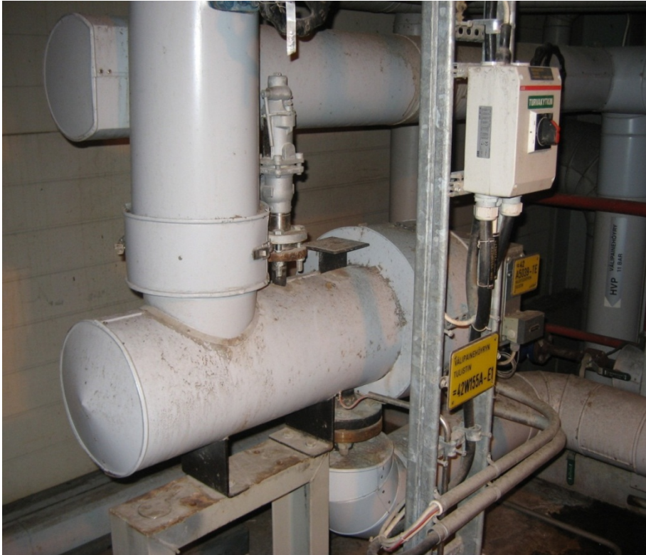
KUVA 14. Sähkötulistin ja varoventtiili
