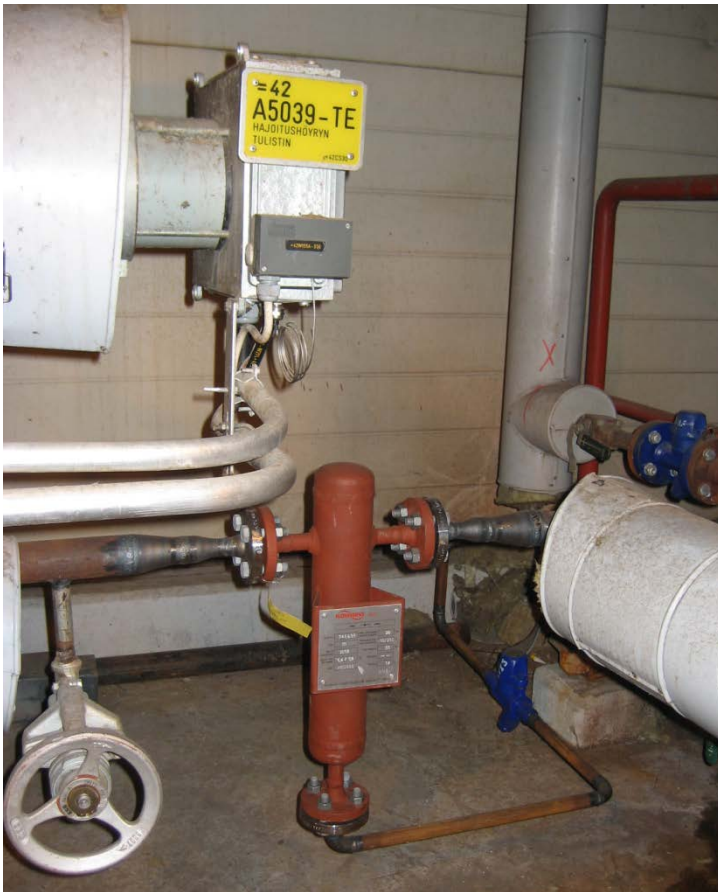
KUVA 26. Pisaranerotin ja biteräslauhteenpoistin ennen sähkötulistinta
