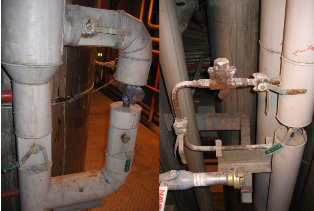
KUVA 18. Biteräslauhteenpoistimet sekä ohitusventtiilit
