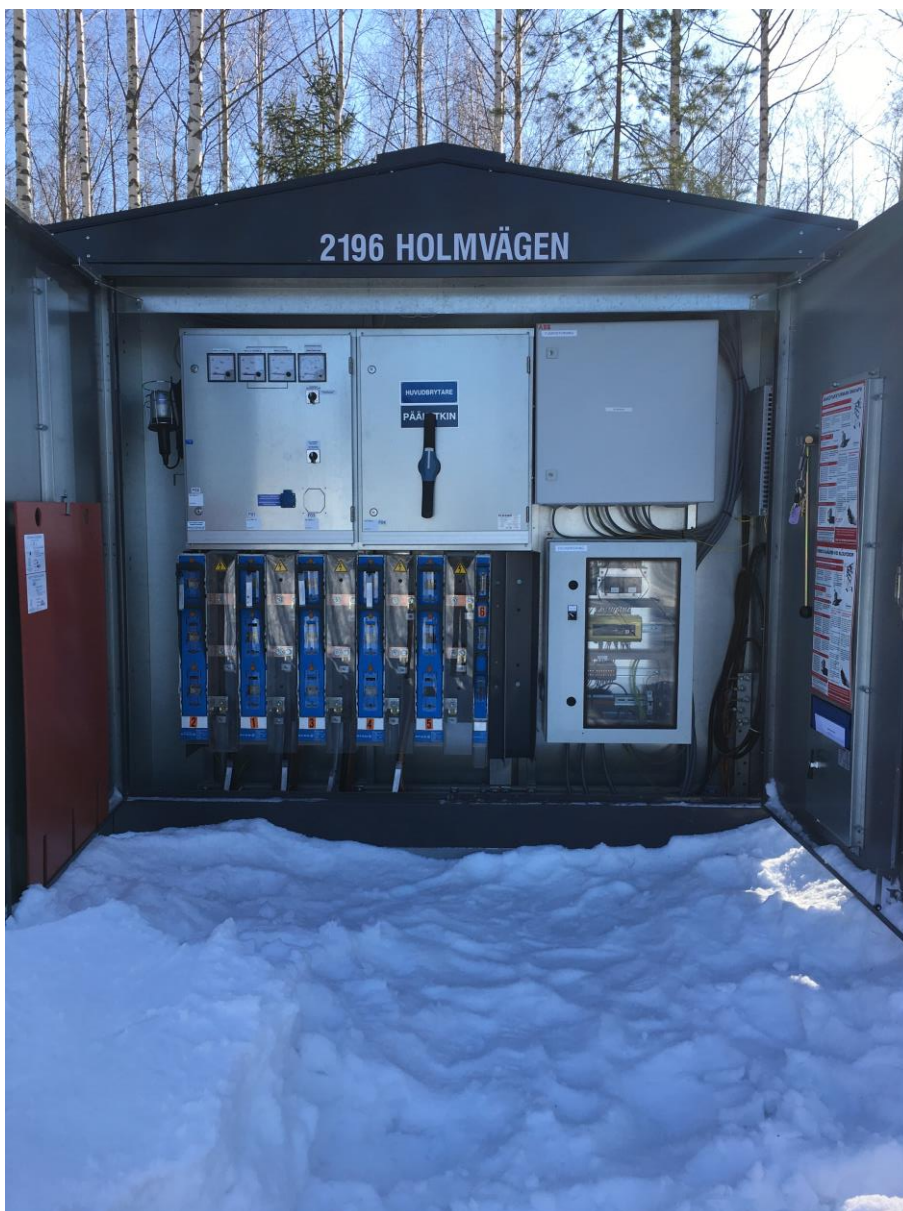
Figur 12. Station med IPC4020 skåp installerat (i nedre högra hörnet).
