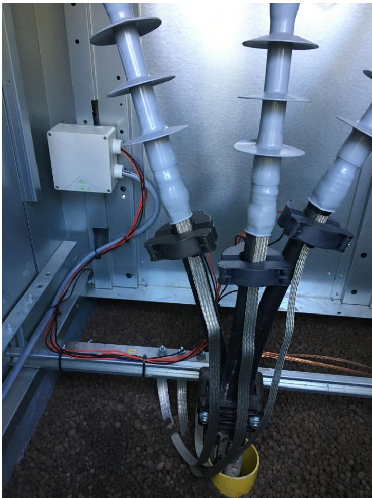
Figur 13. Strömtransformatorer som mäter strömmen i alla faser.
