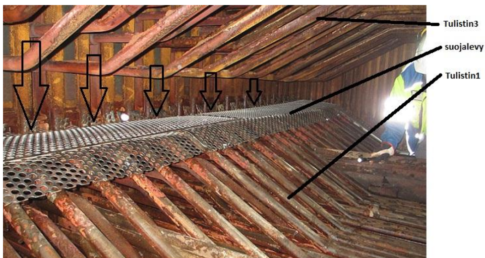
Kuva 17. Uudet reikälevyt tulistin 1 takaseinällä. Nuolet kuvaavat pahinta aluetta. /LIITE 3/
