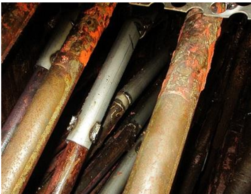
Kuva 18. Tulistin 1:n putkien pinnalle on kiristetty U-muotoinen suoja-levy.
