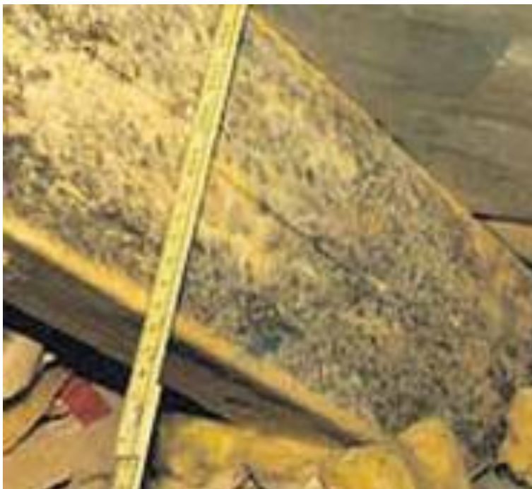
Kuva 26. Homekasvuston vaurioittama puurakenne (Isover 2012).
