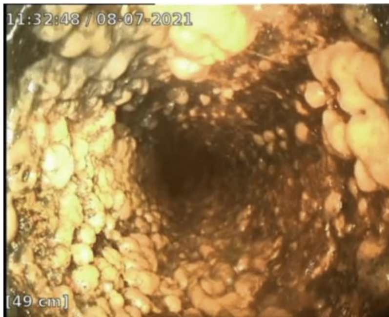
Kuva 11. Korrosio aiheuttaa myös sisäpinnan merkittävää karheutumista, joka lisää tukosriskiä [6]
