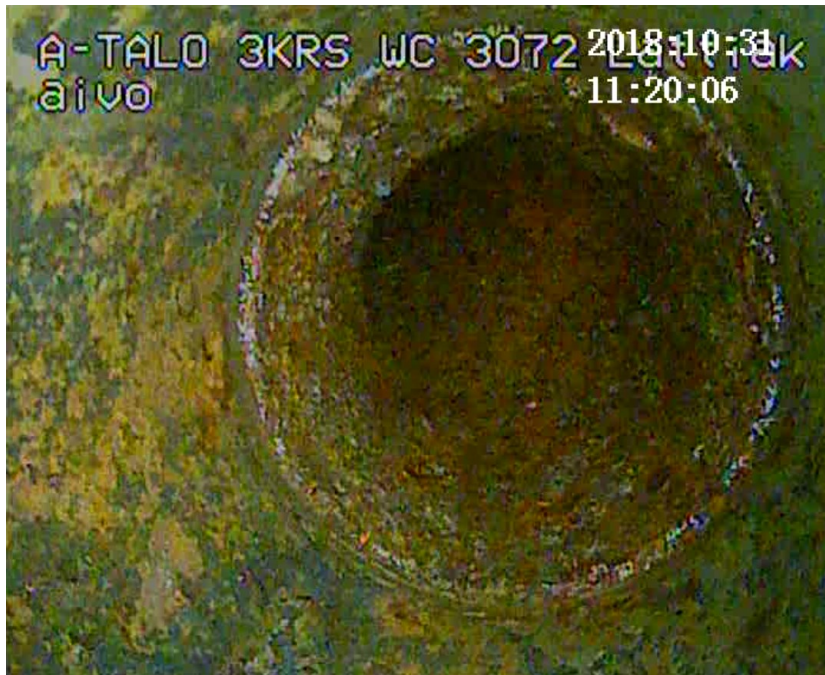
Kuva 9. Viemärin sisäpinnan epoksinnoite on irronnut lähes kokonaan [6]
