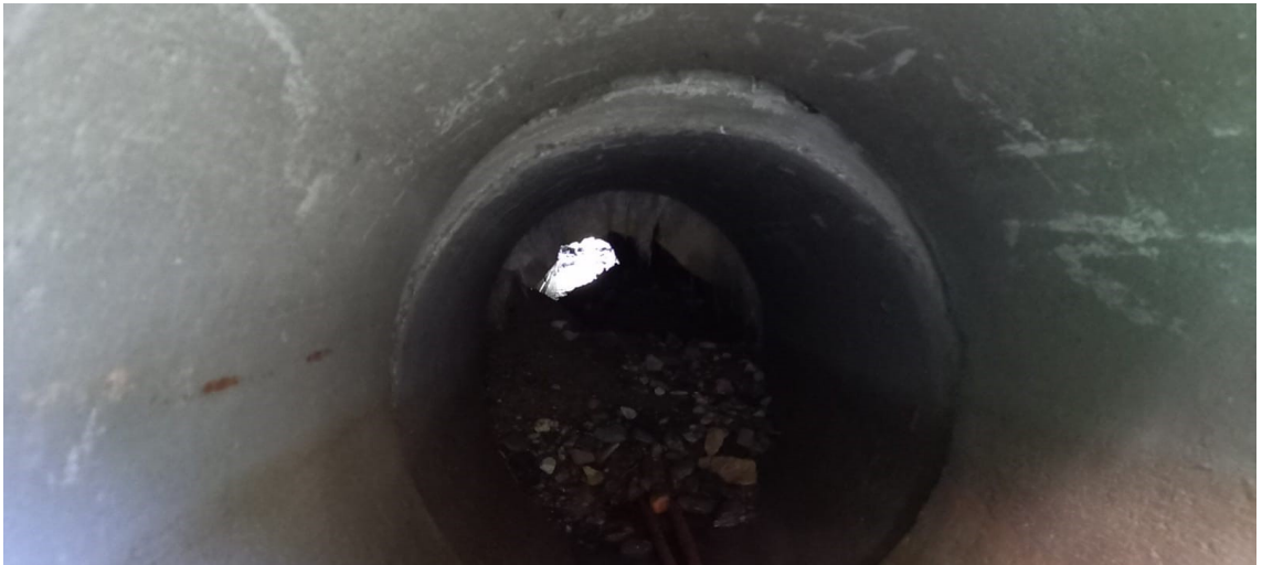
Kuva 9. Soraa valunut betonirumpuun rumpurenkaiden välistä. (Halonen 2021)
