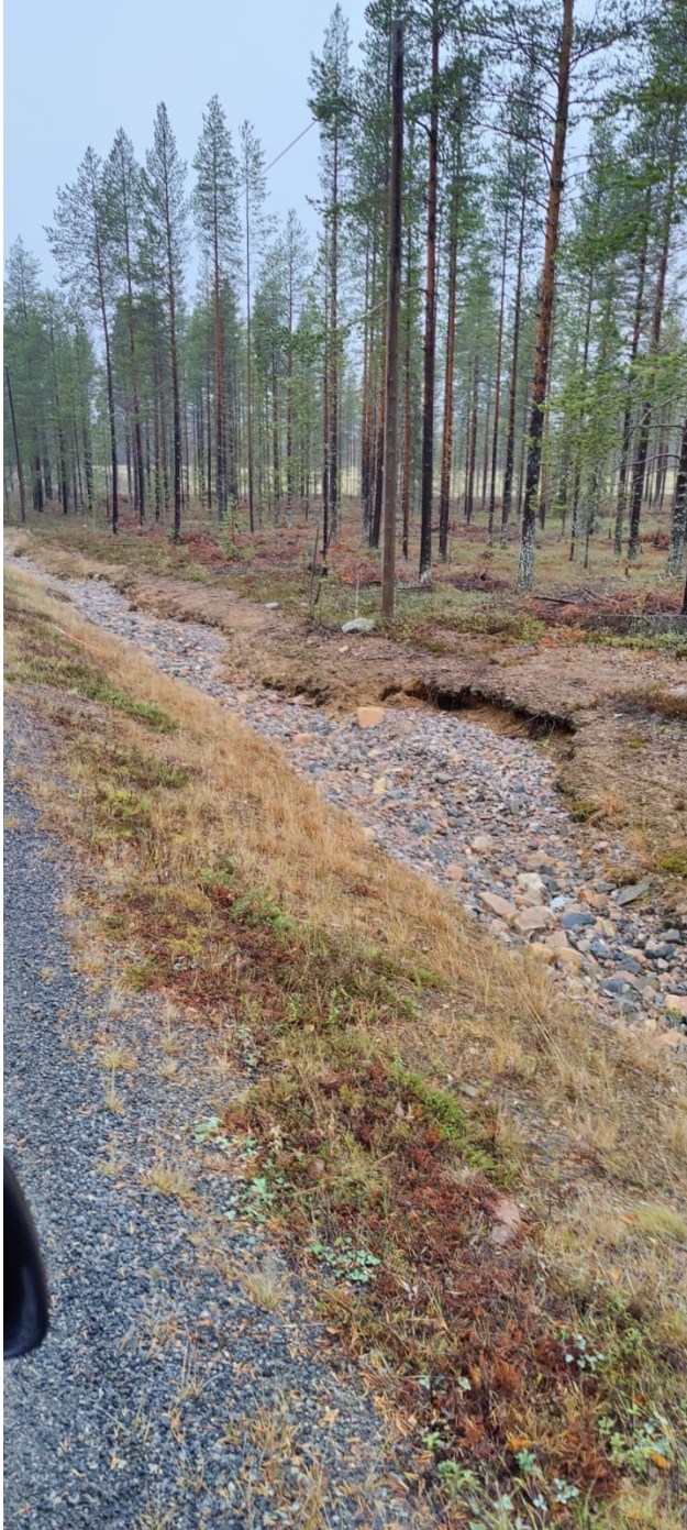
Kuva 6. Luiskavaurio ja louheella parannusta (Karen 2021)
