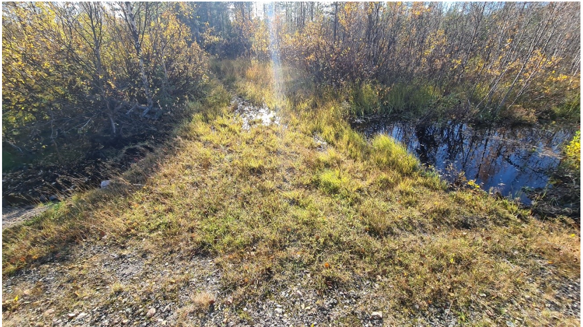
Kuva 14. Sivuojarumpu padottaa vettä
