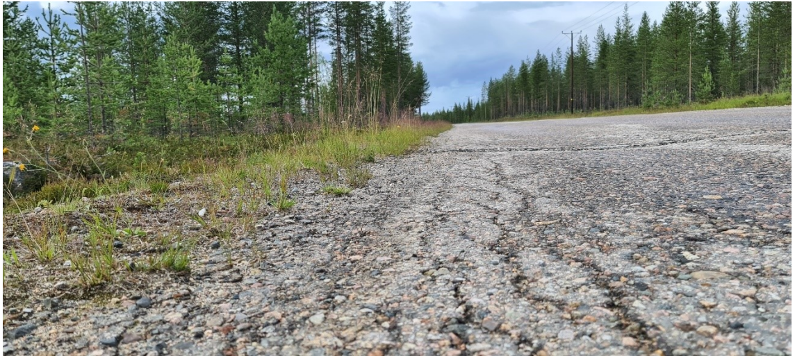
Kuva 5. Reunapalletta ja kuivatuspuutteiden aiheuttamaa verkkohalkeamaa päällysteessä.
