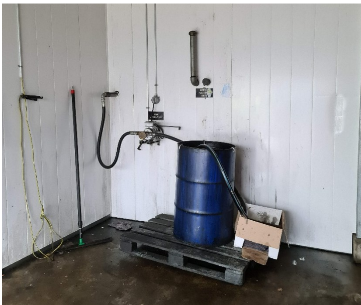
Kuva 27. Reposaaaren kalasatama, öljyn tyhjennysnurkkaus seinän takana oleviin öljysäiliöihin.
