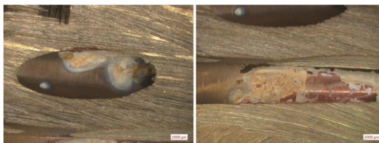
Kuva 3. Näytteen 2 (keittiön hana vuodelta 2014) sisäpinnalla on sinkinkatota, jonka päällä on saostumaa. Oikeanpuoleisessa kuvassa sinkinkatokohdassa sinkki on liennut ja messingin keltainen väri on muuttunut kuparin punaiseksi. (Eurofins Expert Services Oy 2020)
