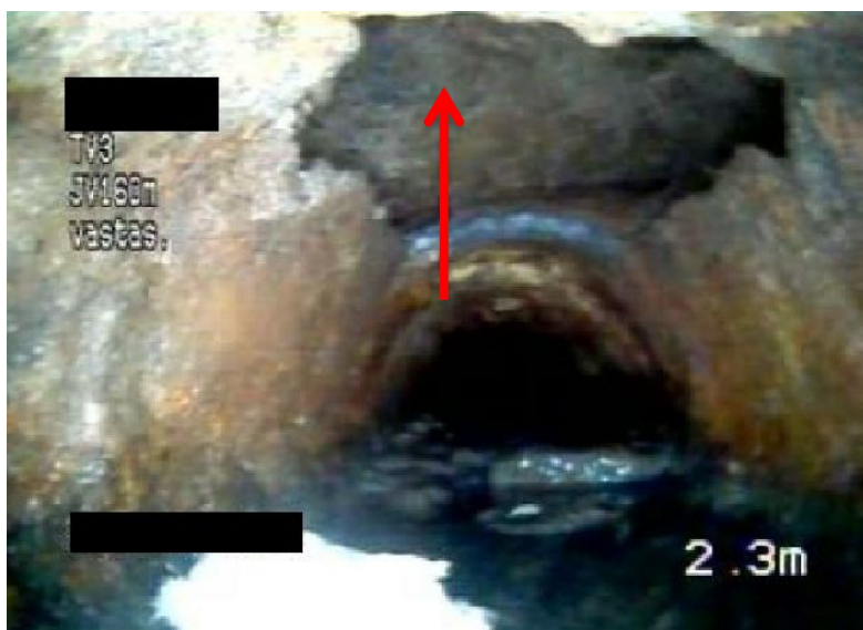
Kuva 9. Sortuma valurautaviemärin yläpinnassa (Vahanen Oy)
