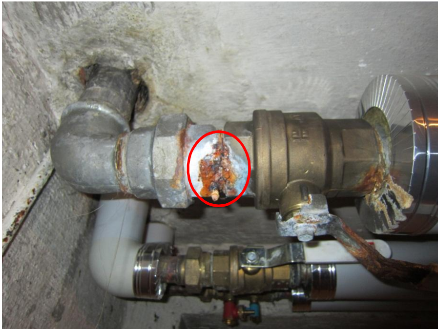
Kuva 2. Vuotojälki kylmän käyttövesijohdon kierrelitospaikassa (Vahänen Oy)
