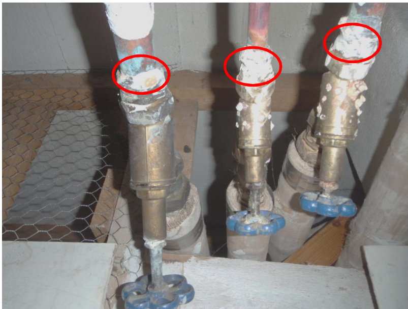
Kuva 6. Sinkinkatoa kupariputkien ja istukkaventtiilien liitoskohdassa (Vahnen Oy)
