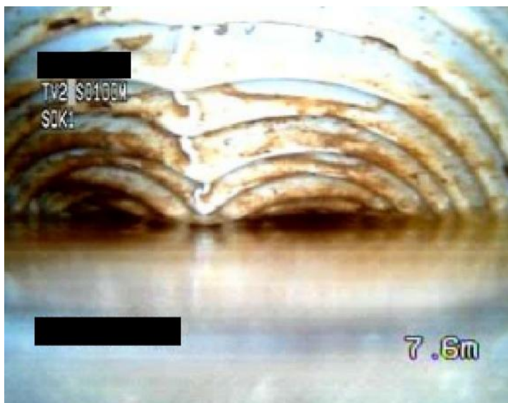
Kuva 12. Salaojaputken yläpinta on painunut kasaan ja putki on täyttynyt vedellä (Vahanen Oy)
