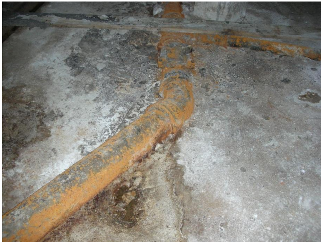
Kuva 8. Valurautaviemärin ulkopinta on altistunut ulkopuoliselle korroosiolle (Vahanen Oy)
