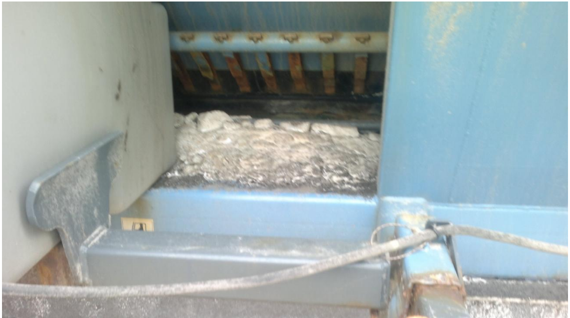
Kuva 7. Suola tekee tehtävänsä suola-automaatin rakenteissa.
