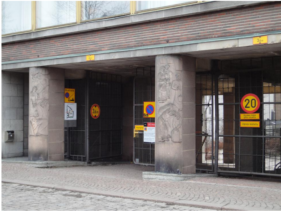
Kuva 11. Pelastustien korkeus ei ole riittävä nostolava-autolle. Kohteessa vapaa tila on 3,6 metriä, kun vaadittu tila olisi 4,6 metriä.
