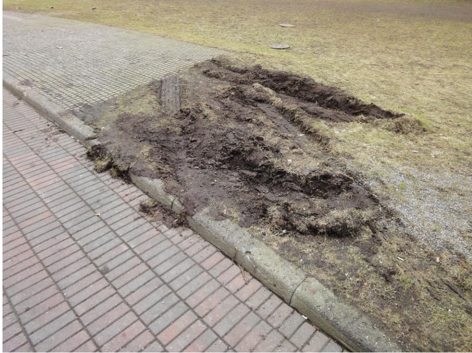
Kuva 17. Nurmikiven ja nurmikon kulutuskestävyydessä on selkeä ero. Jäljet ovat luultavasti aiheutuneet ylläpidon työkoneista. Nurmikivellä vahvistettu alue on tarkoitettu nostoalueen laajennukseksi.
