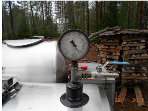
Kuva 8. Tilatankin päällä on alipainemittari ja pallosulkuventtiili. (Kuva: Hannu Piironen.)
