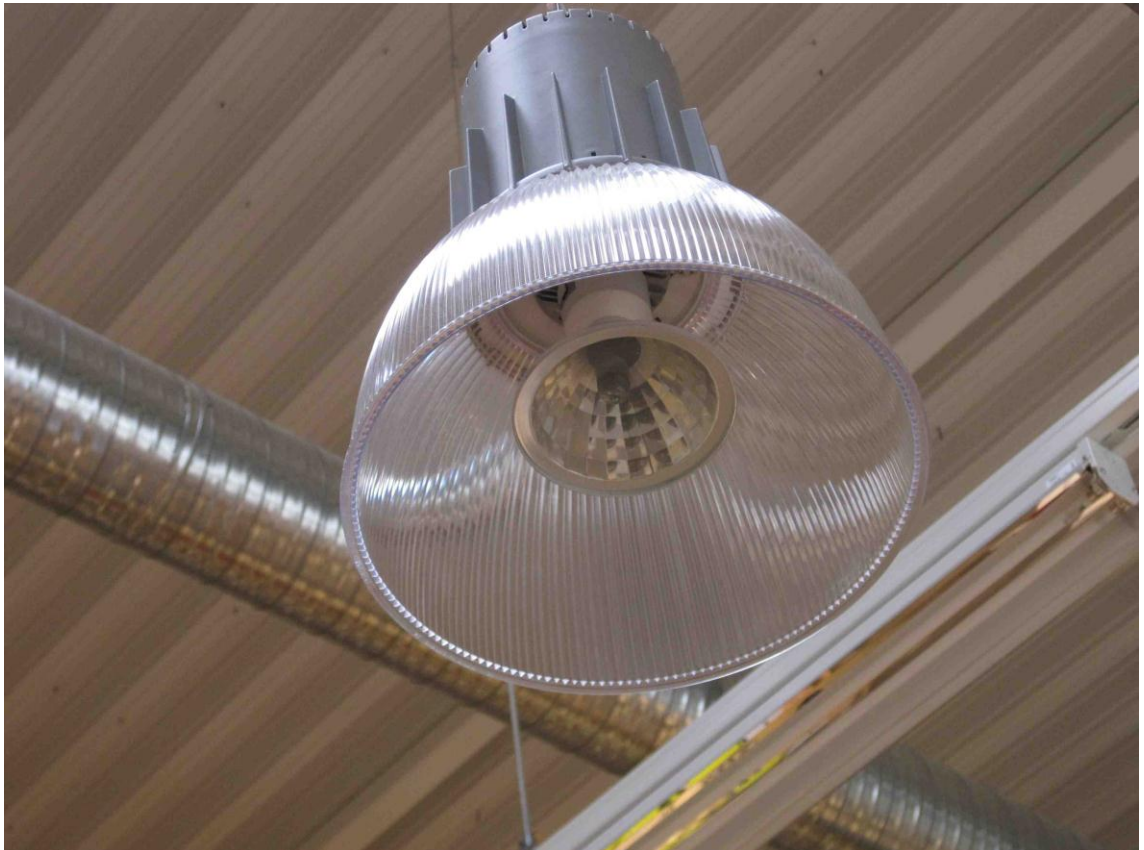
Kuva 3. Monimetalliriippuvalaisin on vanhaa valaistusta, taka-alalla käytöstä pois oleva loisteputkivalaisin.
