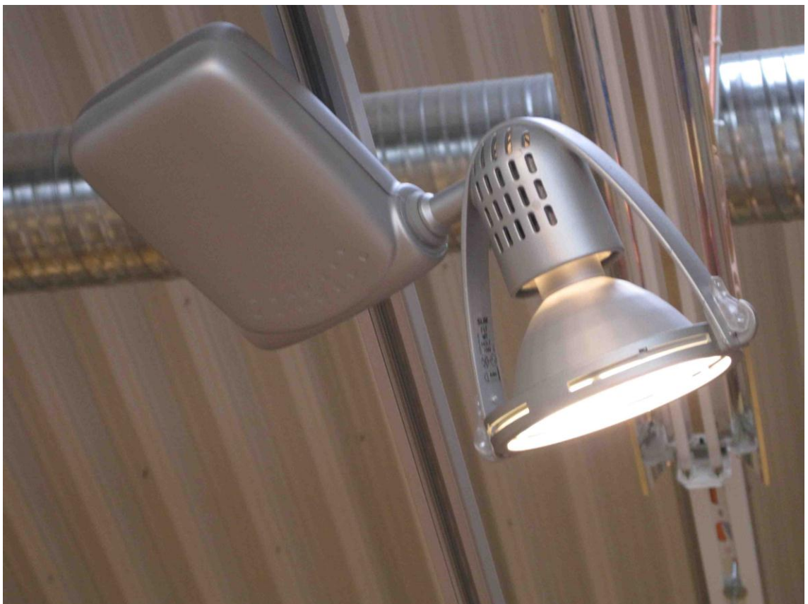
Kuva 4. Monimetallikohdevalaisin on vanhaa valaistusta, taka-alalla loisteputkivalaisin.
