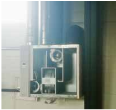
Kuva 4. Teollisuushallissa on koneellinen tulo/poistoilmanvaihto. Tiiviysmittauksen ajaksi koneen raitisilma- ja poistoilmakanavat on tulpattu.
