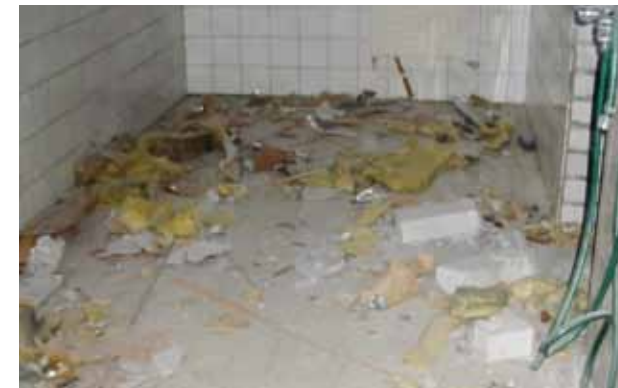
Kuva 1. Työmaan jätehuollon laiminlyönti vaikeuttaa myös työmaan siivousta.
