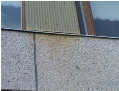
Kuva 2. Peltiverhouksien alapuolilla on tummentumaa.
