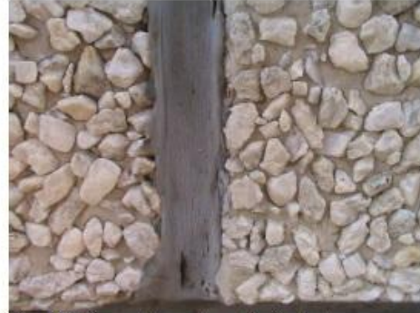
Kuva 10. Elementtisaumat ovat halkeilleet.
