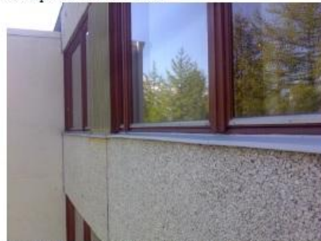
Kuva 24. Ikkunoiden pellitykset ovat liian loivat
