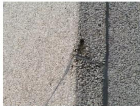
Kuva 5. Teräskorroosion aiheuttamaa halkeamaa ja rapautumaa
