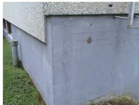
Kuva 12. Rakennuksien murkilla sokkeleiden valusaumoissa on pystyhalkeamia
