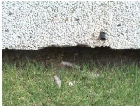
Kuva 21. Kaiteen pieliteräksen korroosion aiheuttamaa lohkeamista
