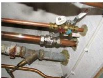
Osa käyttövesiputkista on alkuperäisiä
