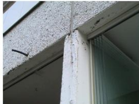
Kuva 17. Pieliteräksen korroosion aiheuttama halkeama
