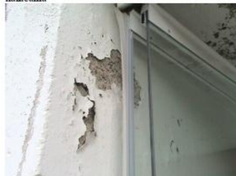
Kuva 18. Pieliseinän yläosan rapautumaa
