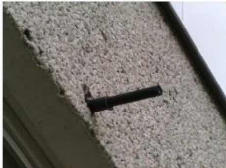
Kuva 14. Liian lyhyttä vedenpoistot putkea on jatkettu
