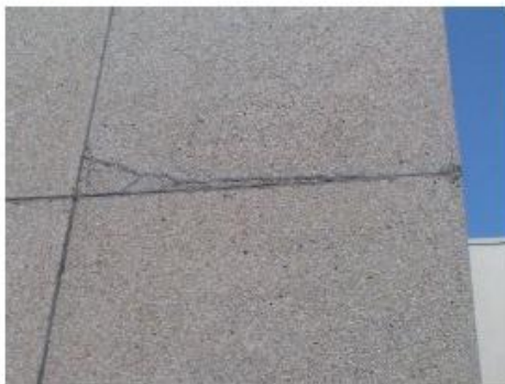
Kuva 3. Vanhoja halkeamia on paikattu elastisella massalla
