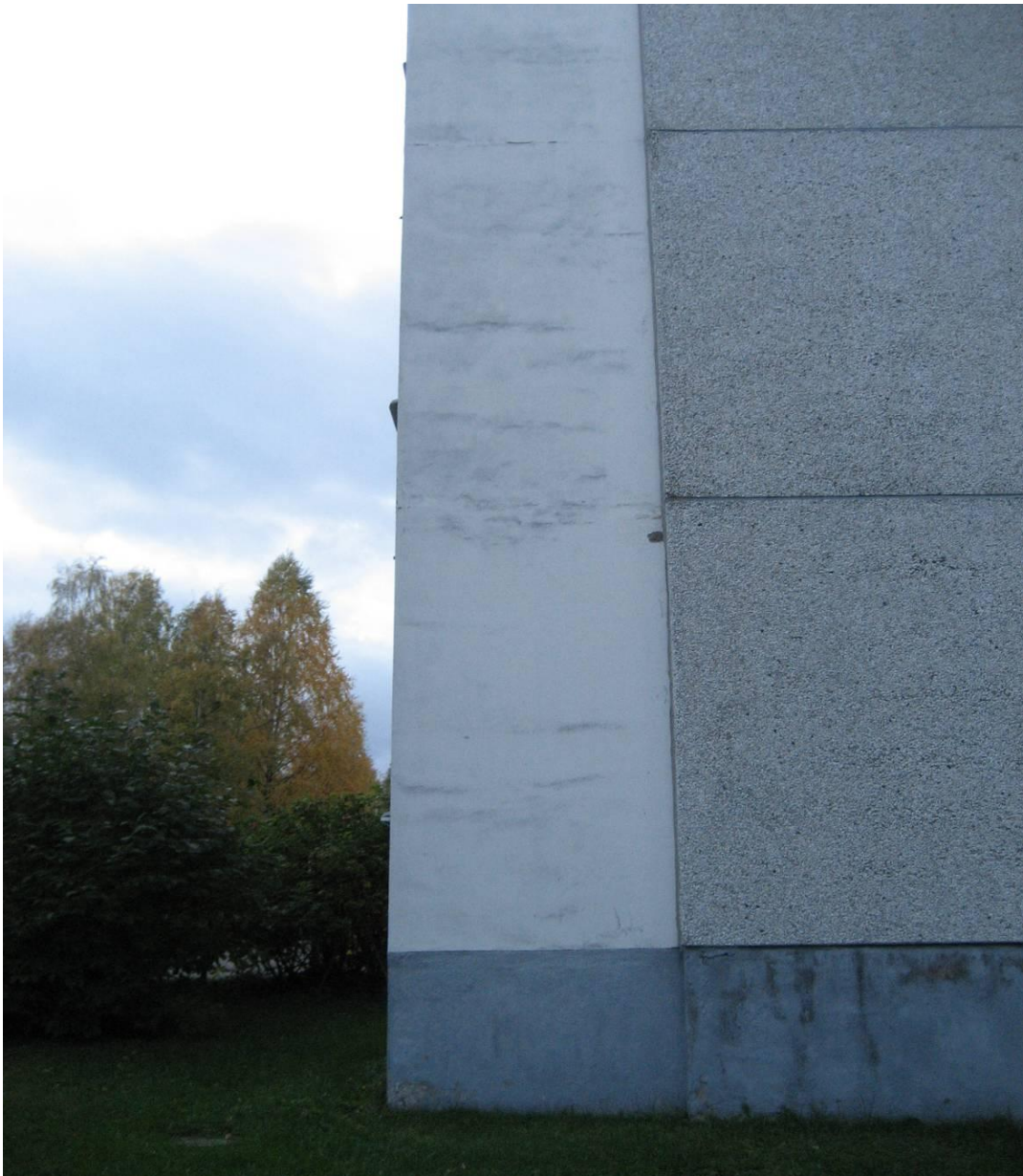
KUVA 7. Parvekkeen pieliseinän maalin hilseilyä
