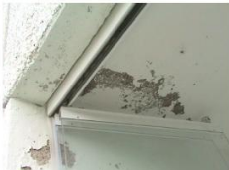
Kuva 15. Maalipinnoitteen hilseilyä parvekelaatan alapinnassa
