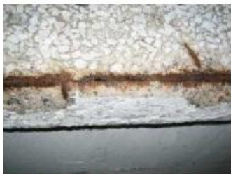
Sandwich-betonielementtien ruostuneita teräksiä.
