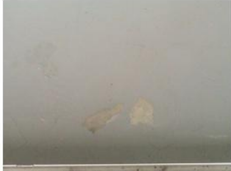
Kuva 13. Laattojen pinnoitteet ovat paikoin hilseilleet
