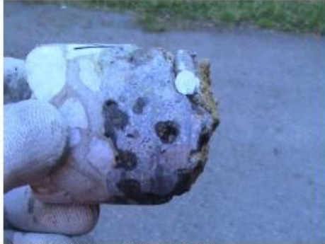
Kuva 7. Sisäpintaan jäänyt teräs, joka on pintaruosteessa
