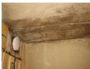
Kattolevyn pintakosteus on koholla.
