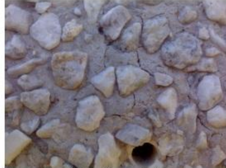
Kuva 4. Elementtipinnoilla on paikoin ohuita halkeamia
