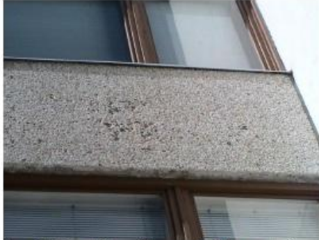
Kuva 1. Elementtipinnoilla on paikoin harventumia
