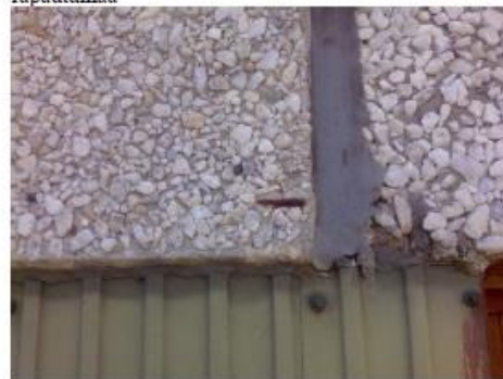
Kuva 6. Ulkopintaan jäänyt ruosteinen teräs
