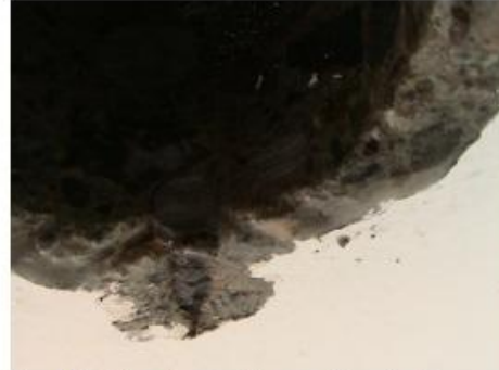
Kuva 16. Liian pinnassa oleva ruosteinen teräs
