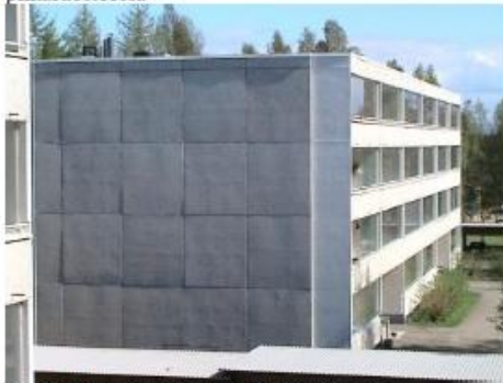
Kuva 8. Päätylelementit ovat käyrystyneet
