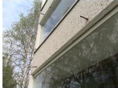
Kuva 22. Teräskorroosion aiheuttamaa helkeamaa
