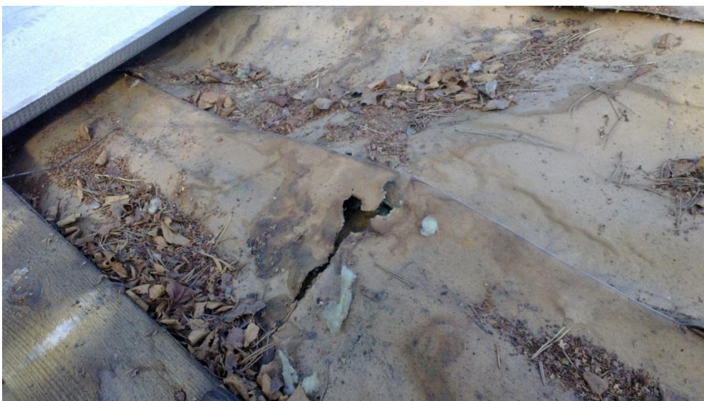
KUVA 1. Aluskate huonossa kunnossa (9)
