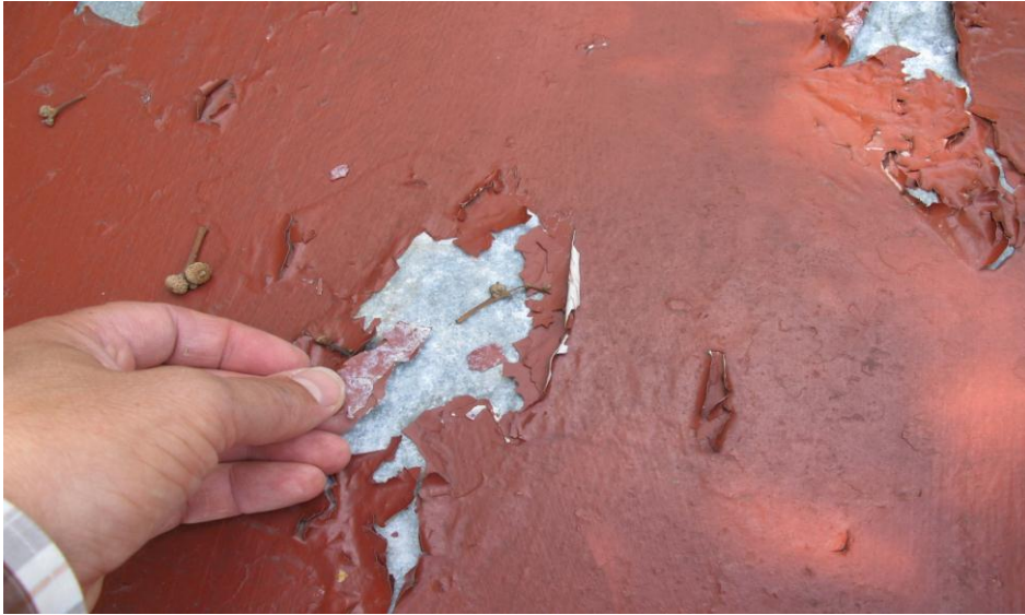
KUVA 2. Peltikaton maalipinnan alla on valkoruostetta (2)
