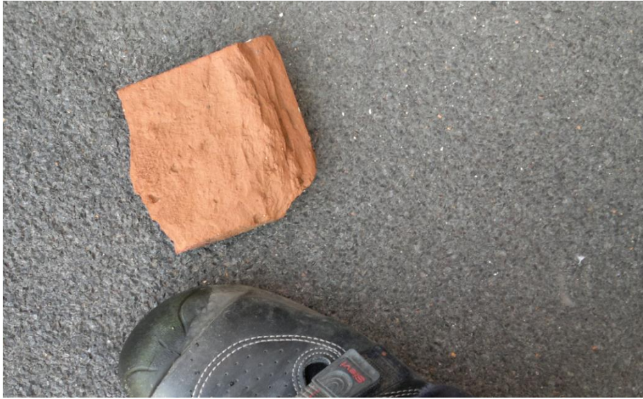
Kuva 2. Seinältä pudonnut tiilenpalanen.
