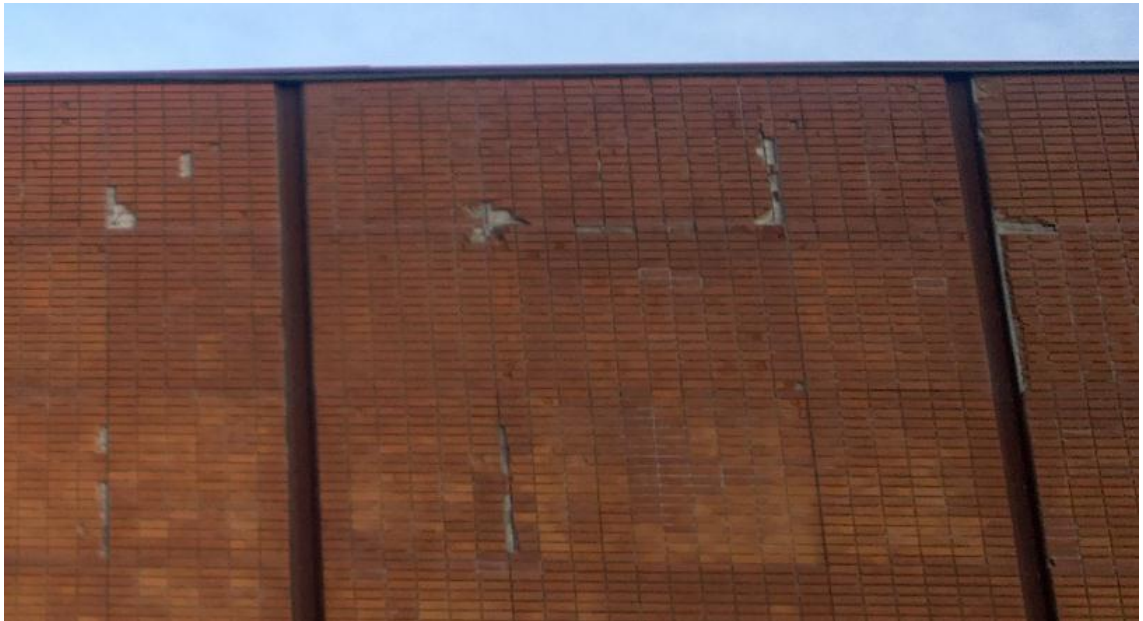
Kuva 1. Sähköaseman seinä, jossa näkyy tiilipinnoituksen kunto rakennuksen yläosassa [1].
