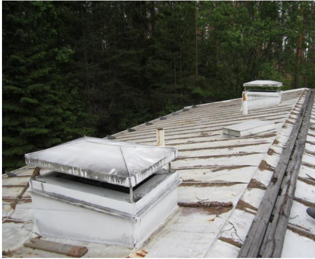
Kuva 22. Vesikatteella on runsaasti kosteutta sitovaa kasvillisuutta.
