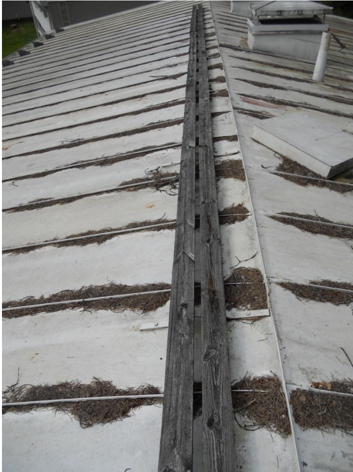
Kuva 28. Kattosillat ovat lahonneet.
