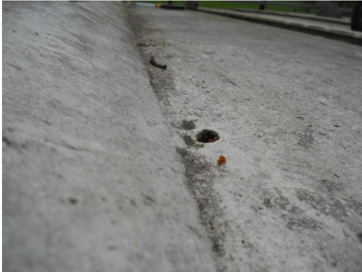
Kuva 24. Vesikatteesta löytyi pieniä reikiä.
