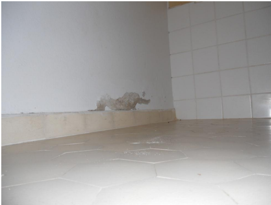
Kuva 49. Kosteusrasitusta pesuhuoneiden seinissä.
