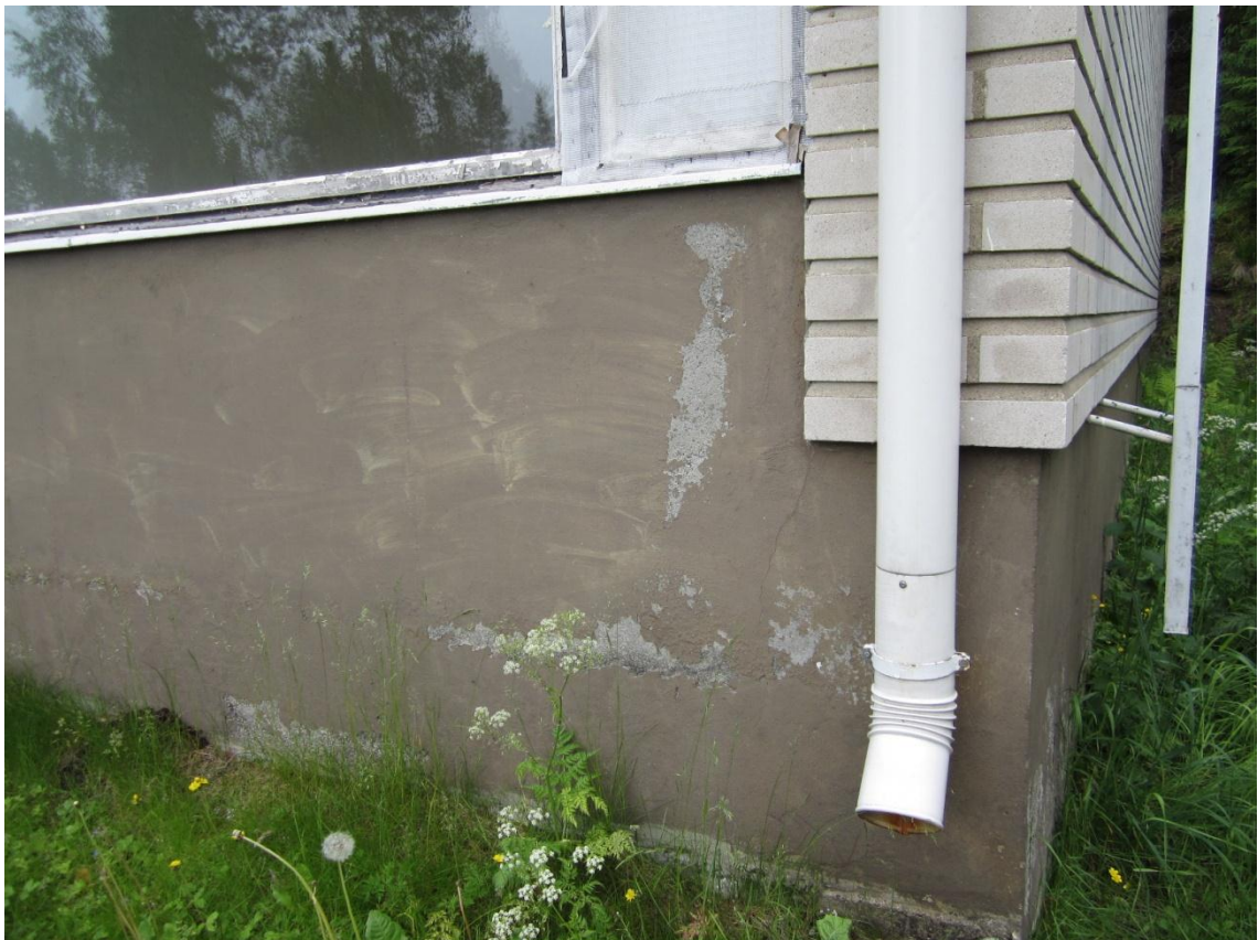
Kuva 17. Sivuseinällä lattiapinta erottuu selvästi irronneen pinnoitteen kohdalla.
