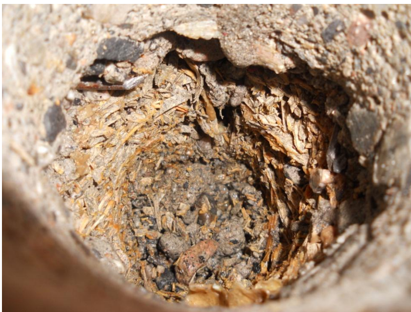
Kuva 9. Alapohjan eristekerros ja huonokuntoinen betonilaatta.
