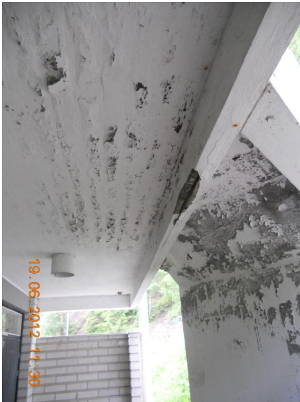
Kuva 20. Betoniportaiden rapautumisesta ja raudoitteiden korroosiosta syntyneitä vauriota.
