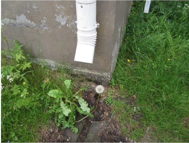
Kuva 16. Puutteellinen sadeveden poisto.
