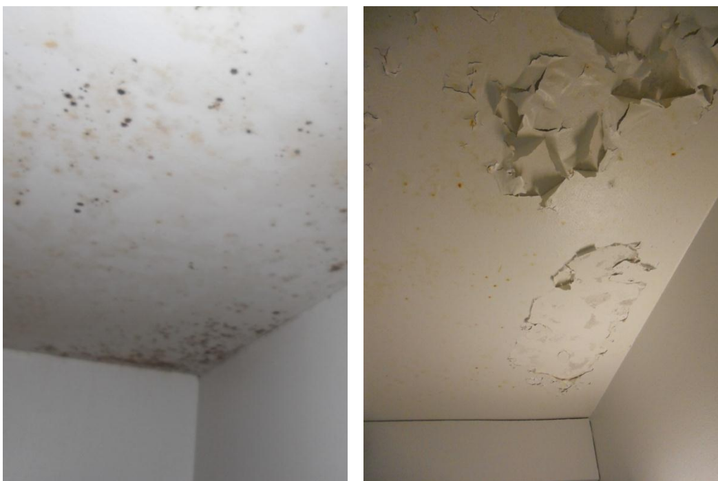
Kuva 38. Lähes kaikkien pesuhuoneiden katoissa on tiivistyneen kosteuden aiheuttamia vaurioita.
