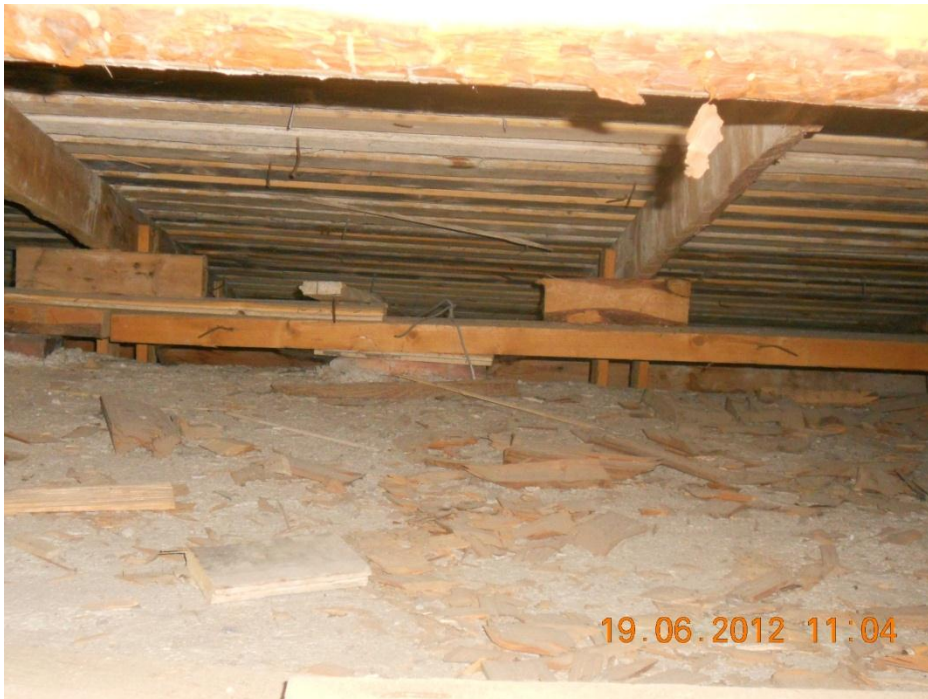
Kuva 29. Yläpohjassa on sinne kuulumatonta jätettä.
