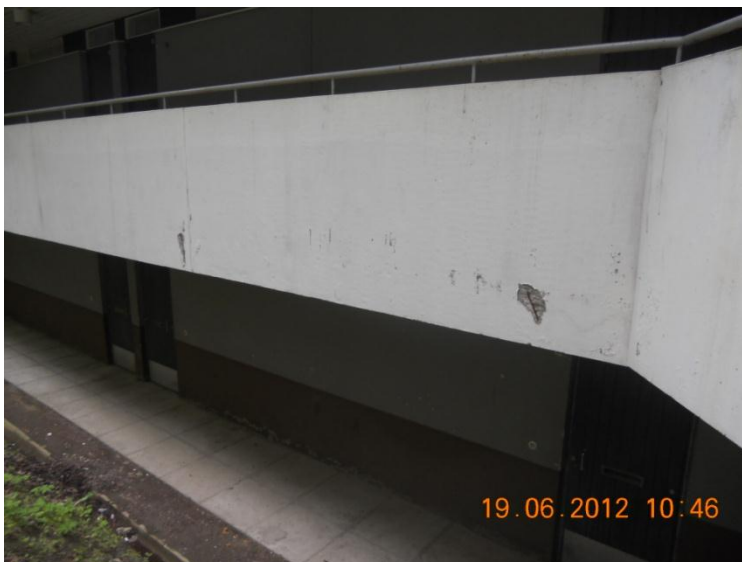
Kuva 21. Parvekekaiteen raudotteiden korroosiovauriota.
