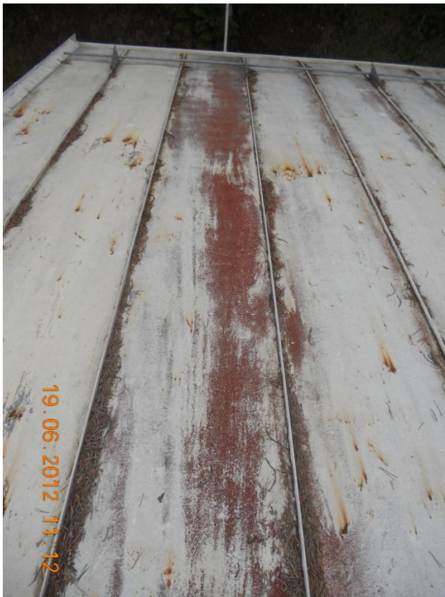
Kuva 23. Vesikatteella on ruostetta ja tunnistamatonta jälkeä.
