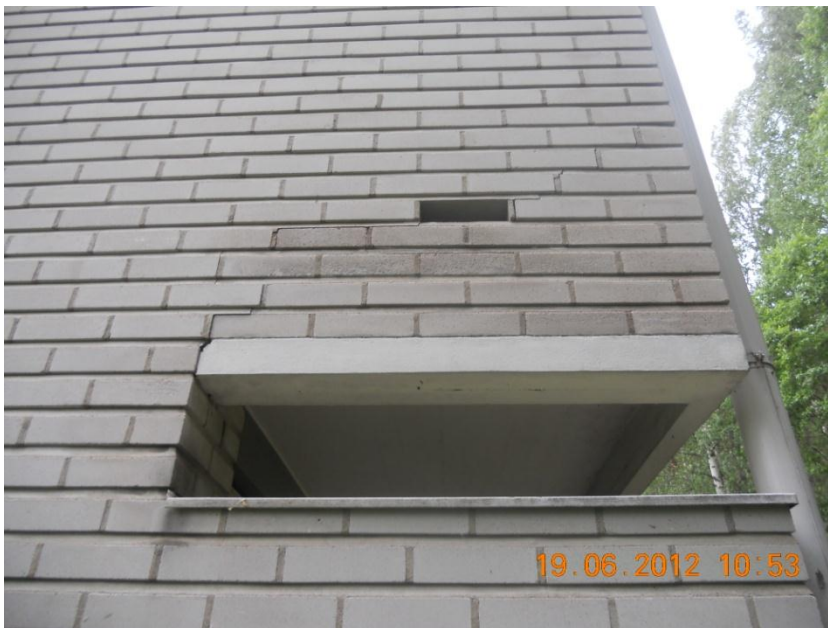
Kuva 18. Ilmeisesti luhtikäytävän laatan kertaluonteinen notkahdus on aiheuttanut tiiliverhouksen halkeamisen.
