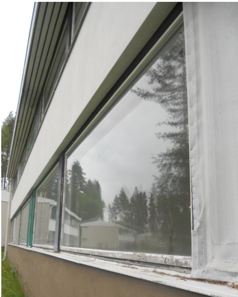
Kuva 19. Huonokuntainen ikkuna ja puutteellinen kallistus vesipellitissä.
