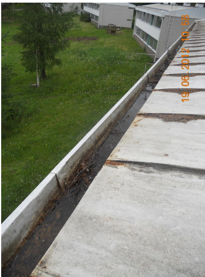
Kuva 27. Vesi seisoo räystäskouruissa.
