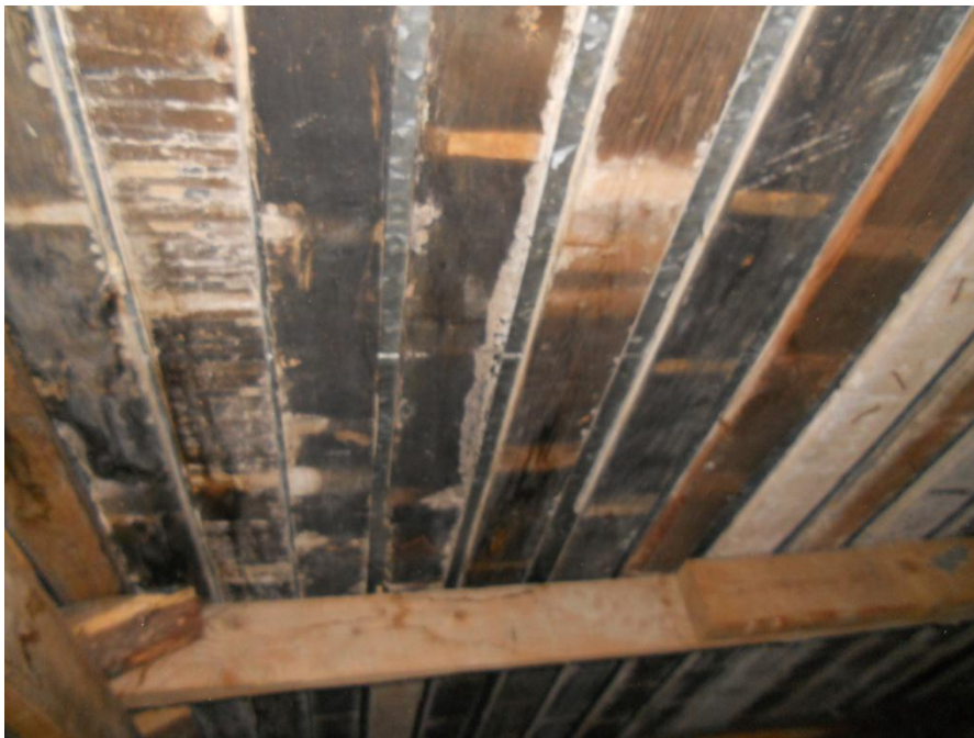
Kuva 31. Vesikatteen aluslaudoitus on tummunut.
