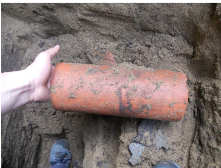
Kuva 16. Salaojana toimiva savitiiliputki.
