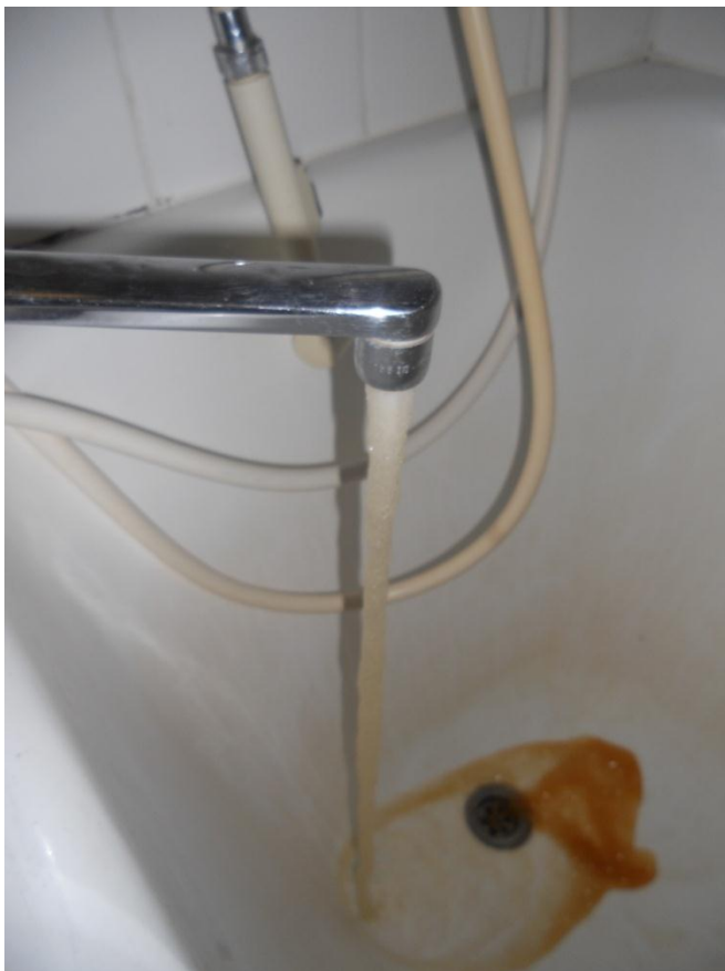
Kuva 32. Vesihanoista tulee ruosteista vettä.
