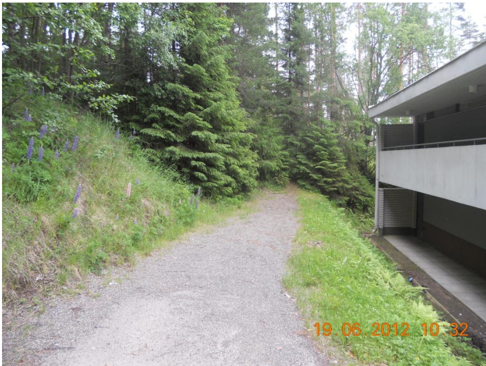
Kuva 13. Sulamisvedet valuvat rakennuksiin.
