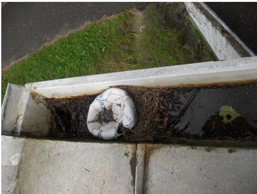
Kuva 26. Räystäskourut vaativat puhdistusta.
