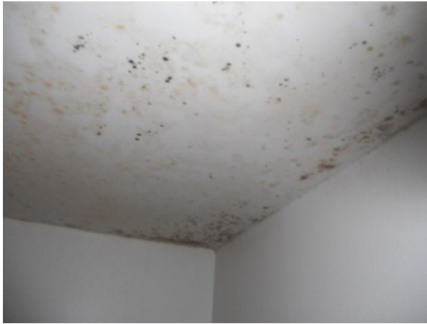
Kuva 10. Pesuhuoneiden katossa mikrobikasvustoa.
