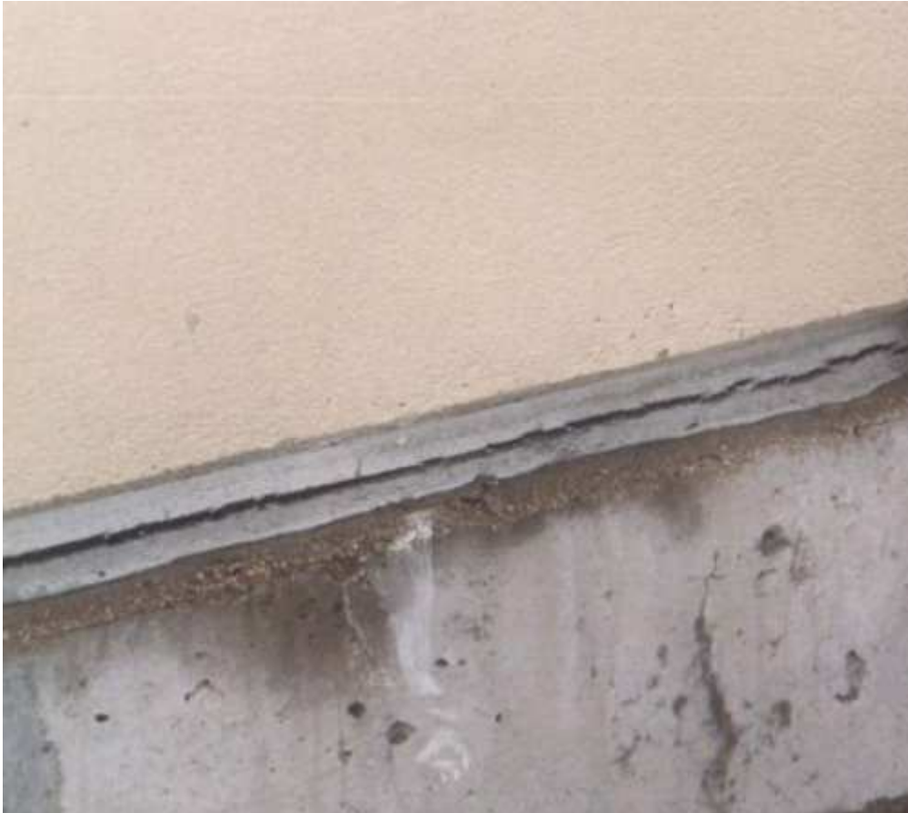
KUVA 2. Sokkeli- ja ulkoseinäelementin välisen sauman lohkeama (11)
