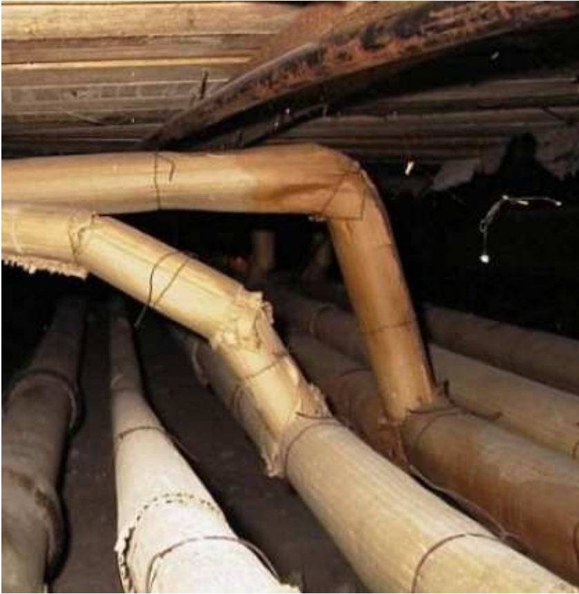
KUVA 4. Huonosti eristetty vesijohto (10)
