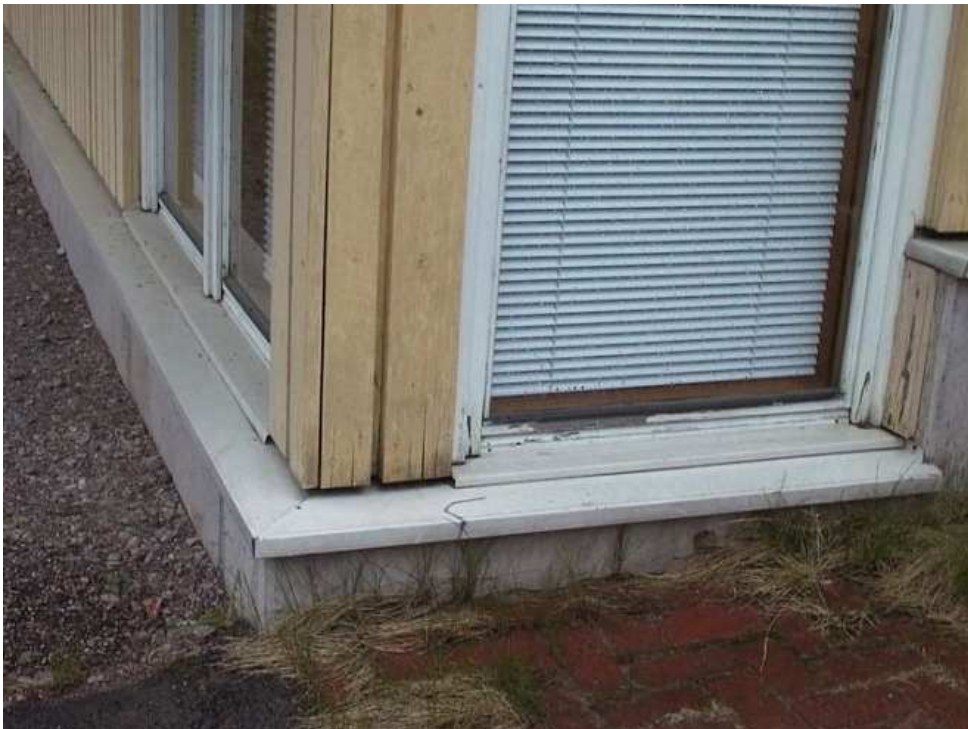
KUVA 1. Liian lähellä maan pintaa oleva vaurioitunut puurakenne (8)
