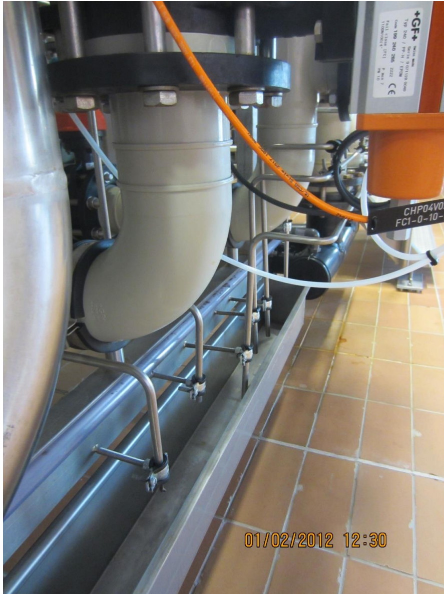
Kuva 9. Vuodonilmaisventtiilien vuodonilmaisuputket kaukalossa.
