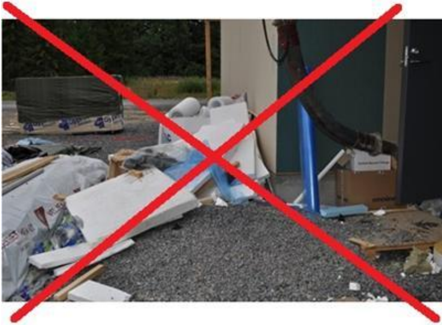
KUVA 3. Huolimattomasti hoidettu jätteidenlajittelu on työ- ja paloturvallisuus riski (14)
