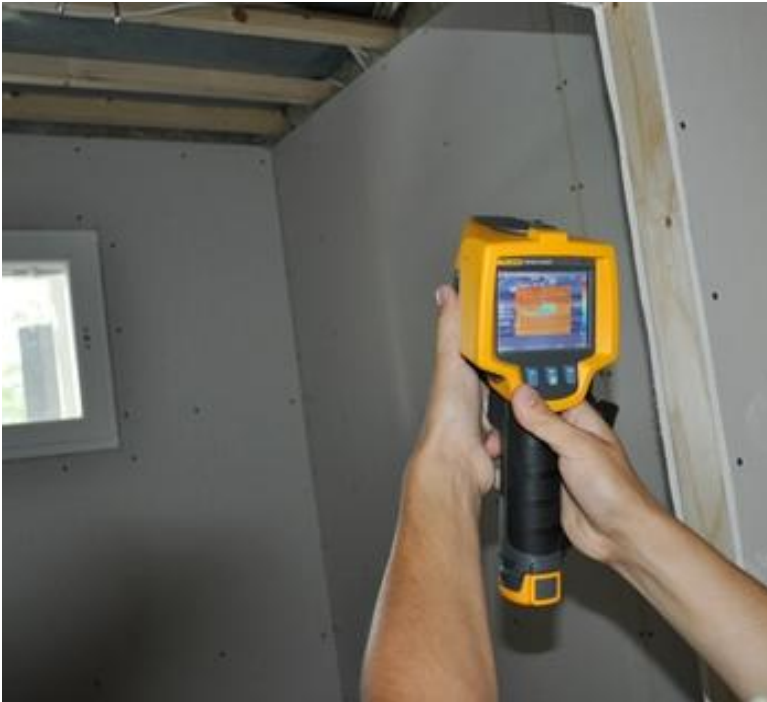
KUVA 8. Lämpökamerakuva paljastaa ilmanvuotokohdat (14)
