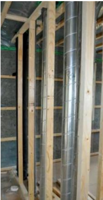
KUVA 22. Vahvennetun väliseinän putkitukset (14)
