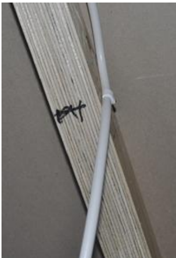
KUVA 17. Johto runkotolpan kohdalla (14)
