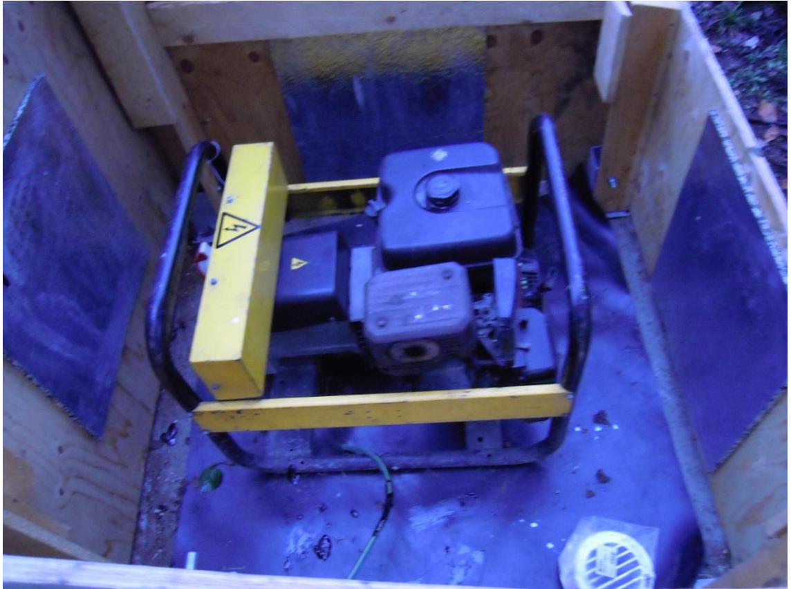
Kuva 11. 6 kW:n bensiiniaggregaatti sille rakennetussa kopissa
