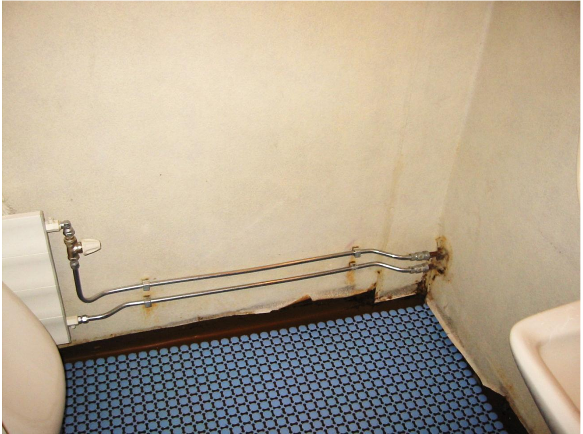
Kuva 1. Kosteusvaurioitunut kylpyhuone, jossa mm. virheellisiä seinien läpivientejä ja seinäta- petit alkaneet irrota
