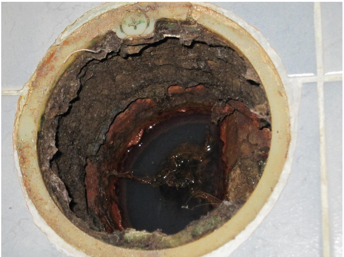
Kuva 5. Vanha huonokuntoinen valurautainen lattiakaivo
