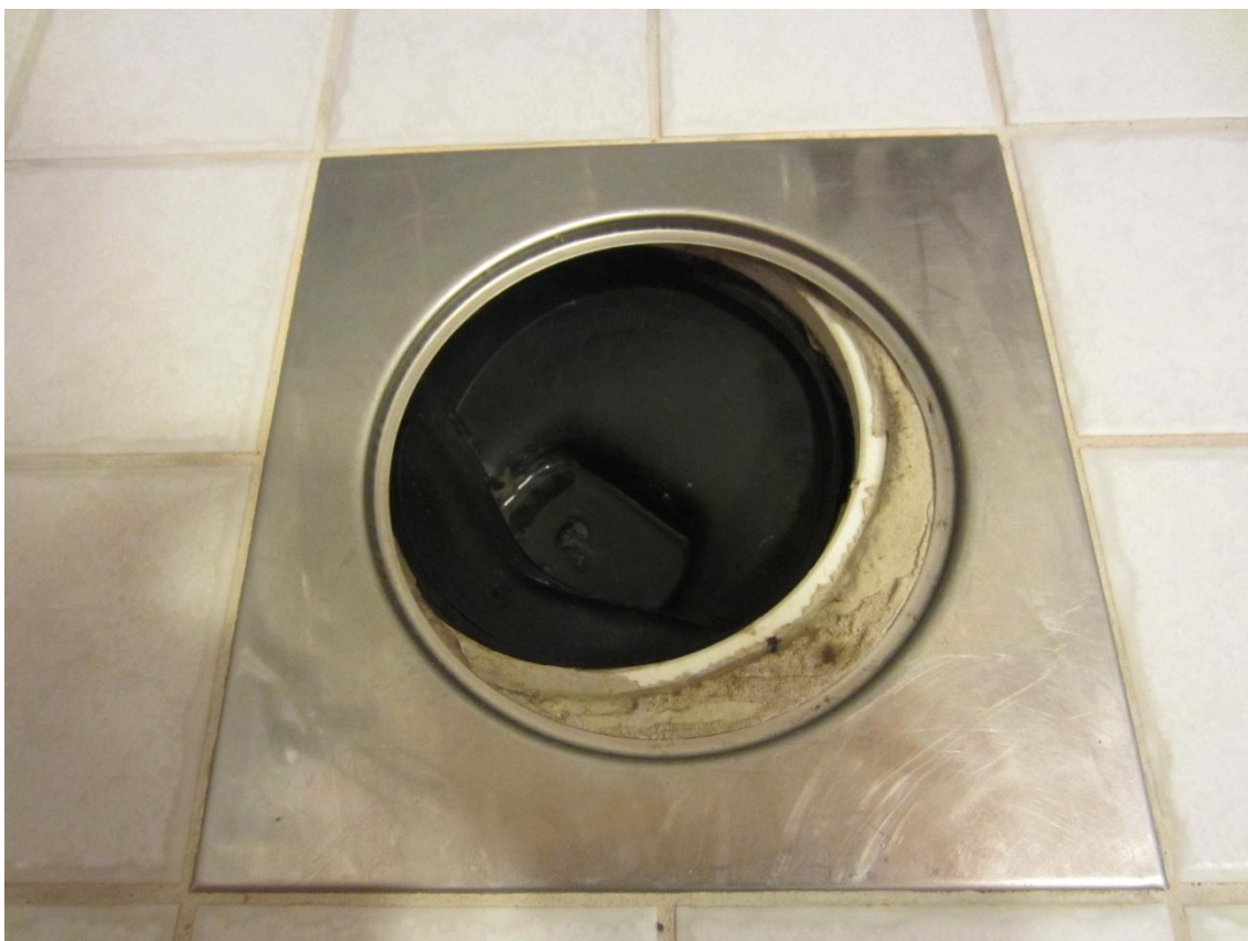
Kuva 8. Lattiakaivolle väärin keskitetty ja väärällä sauma-aineella asennettu Serres-kehys
