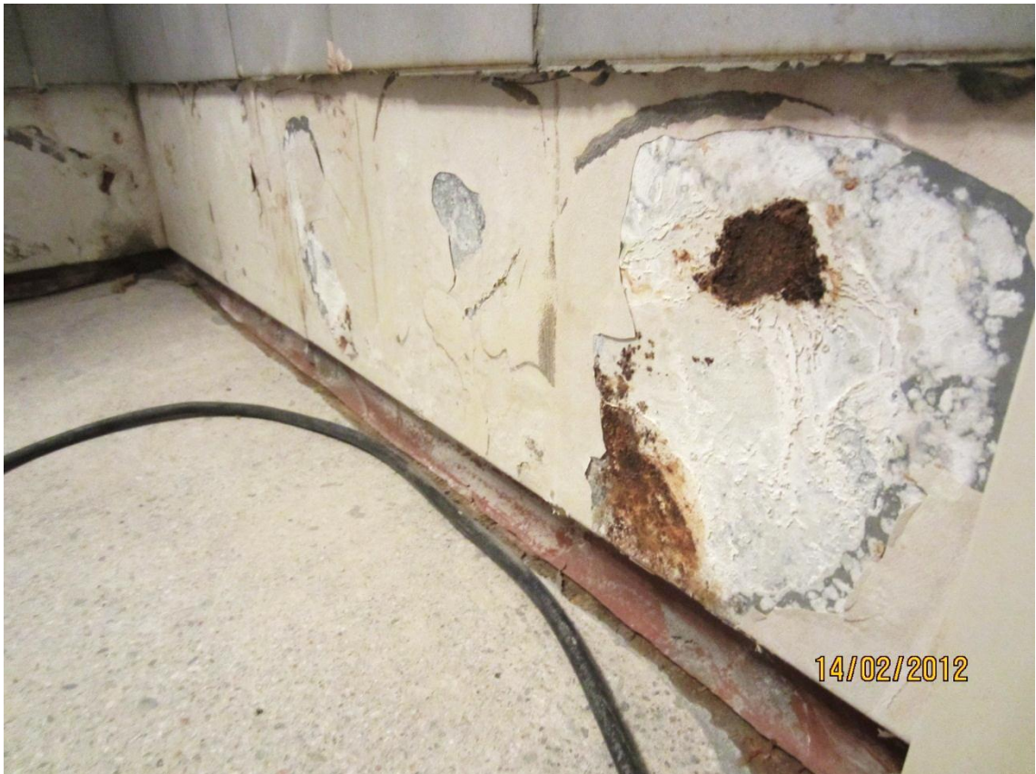
Kuva 2. Korroosioaurioita peltikasettiseinässä, puretun alimman seinälaattarivin alla
